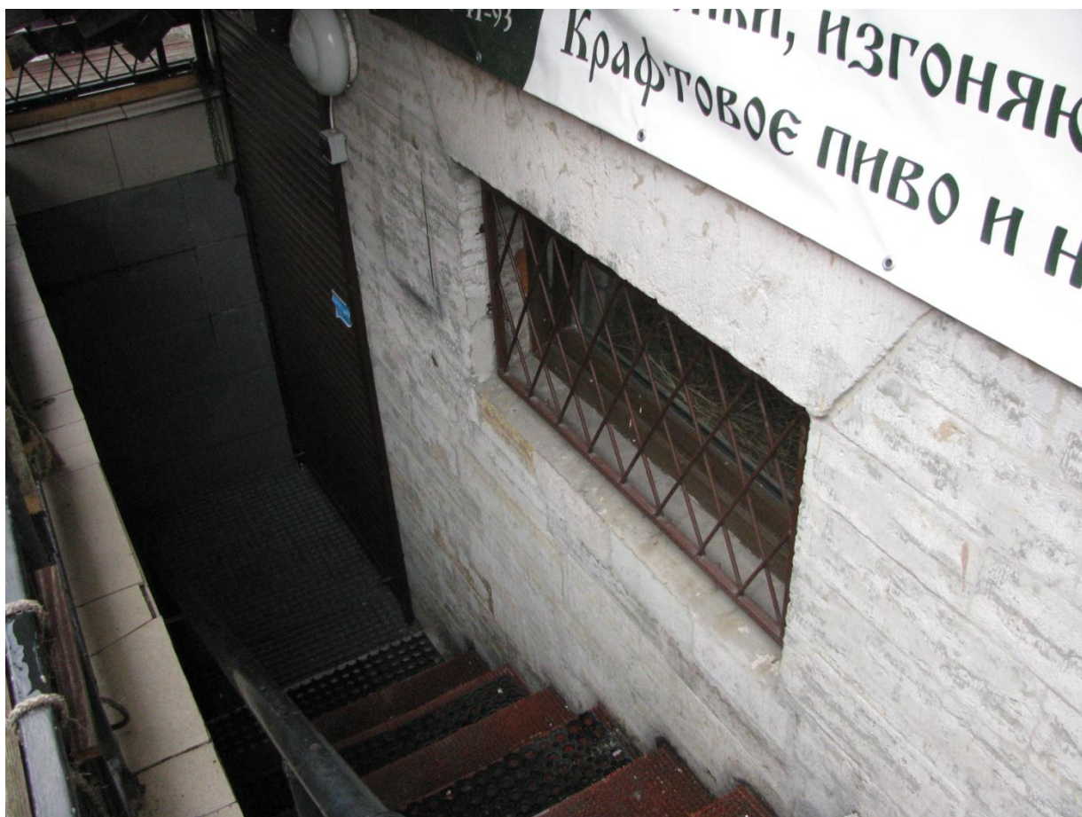
3. Прямо́к, ведущий в помеще́ние 3-Н выявленно́го объеќта культу́рного насле́дия «До́м Л. Бру́нса»
