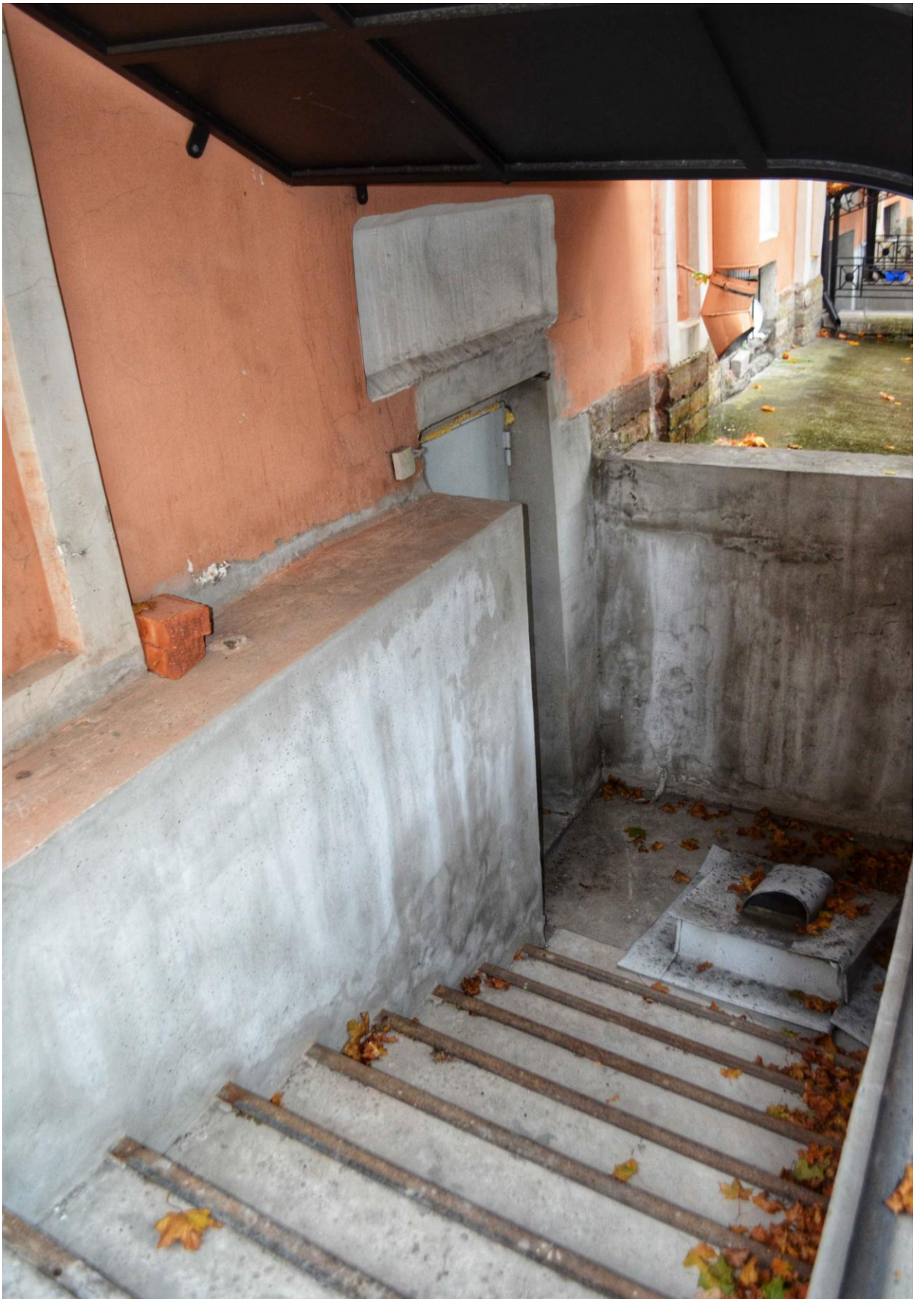
Фото 32. ОКН федерального значения «Корпус Духовской» (наб. реки Монастырки, дом 1, литера Д). Восточный фасад. Вход в подвальное помещение. Фрагмент. Съёмка 23.10.2020 г.
