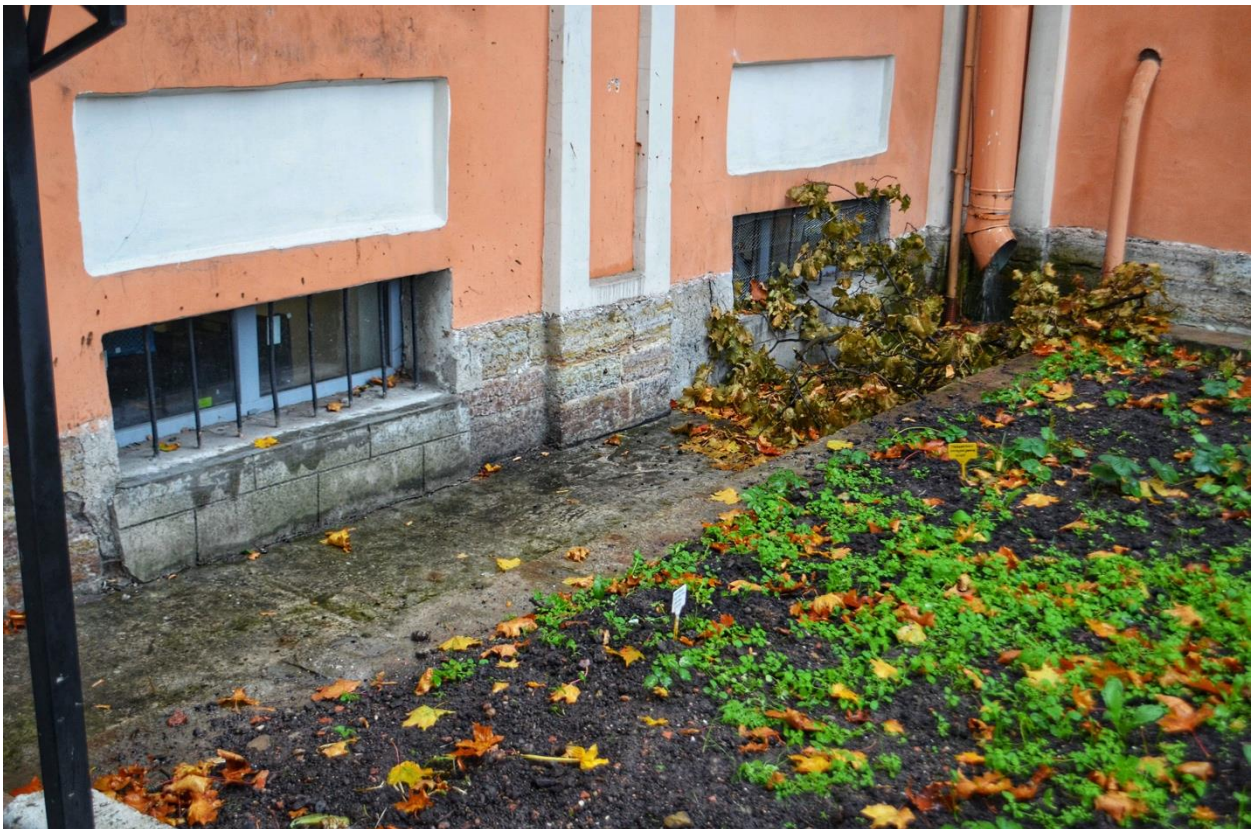
Фото 34. ОКН федерального значения «Корпус Духовской» (наб. реки Монастырки, дом 1, литера Д). Восточный фасад. Цоколь. Фрагмент. Съёмка 23.10.2020 г.
