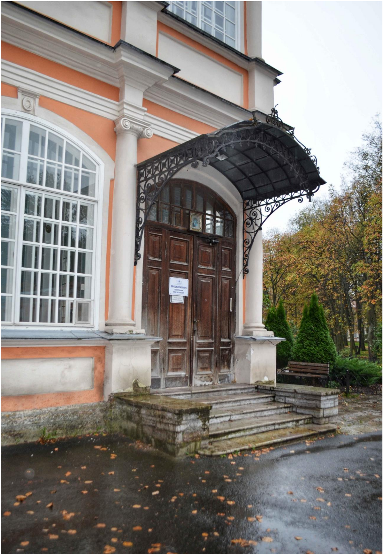
Фото 10. ОКН федерального значения «Корпус Духовской» (наб. реки Монастырки, дом 1, литера Д). Западный фасад. Крыльцо. Съёмка 23.10.2020 г.
