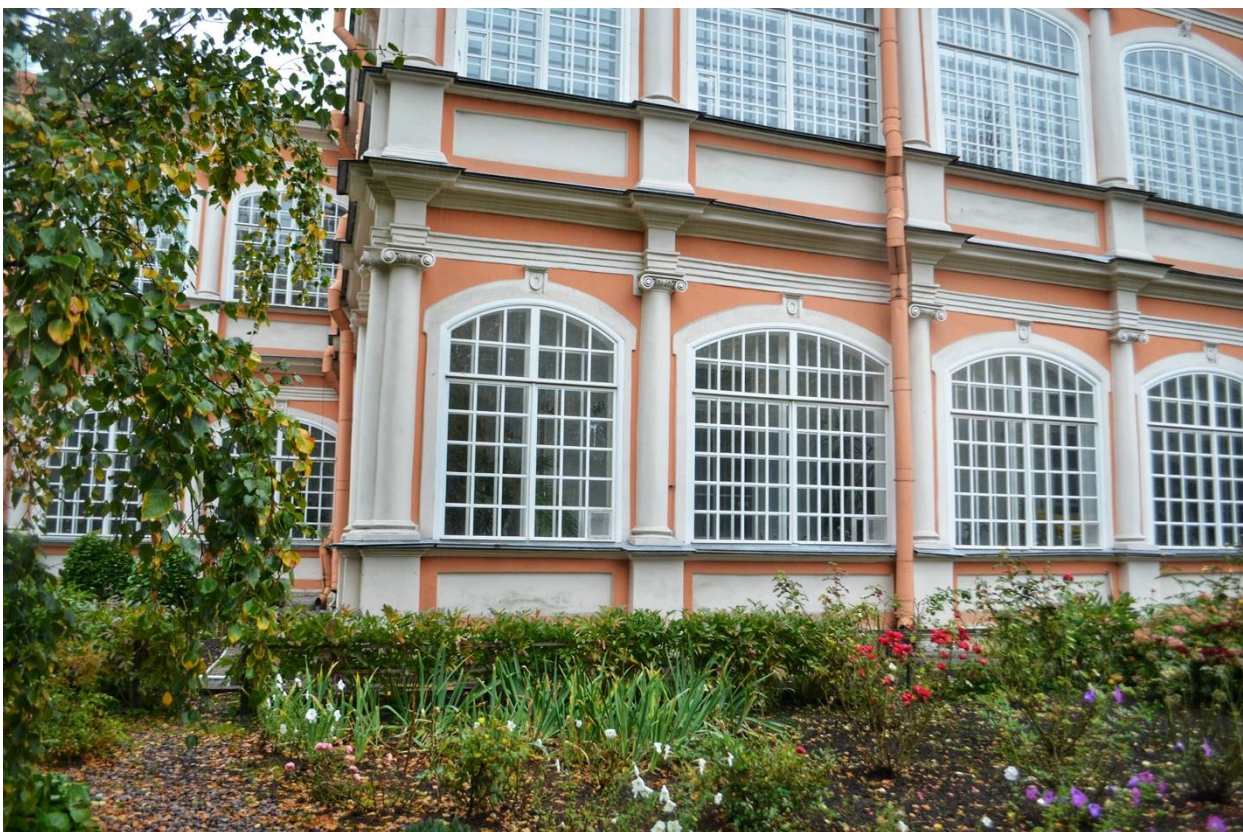
Фото 17. ОКН федерального значения «Корпус Духовской» (наб. реки Монастырки, дом 1, литера Д). Западный фасад. Фрагмент. Съёмка 23.10.2020 г.
