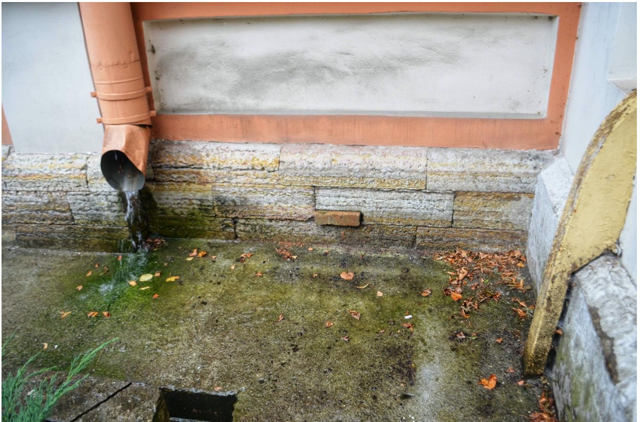
Фото 21. ОКН федерального значения «Корпус Духовской» (наб. реки Монастырки, дом 1, литера Д). Западный фасад. Фрагмент. Съёмка 23.10.2020 г.
