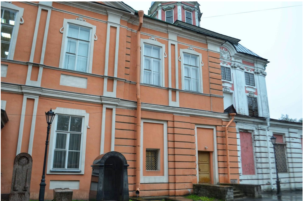
Фото 58. ОКН федерального значения «Корпус Духовской» (наб. реки Монастырки, дом 1, литера Д). Восточный фасад. Фрагмент. Съёмка 23.10.2020 г.
