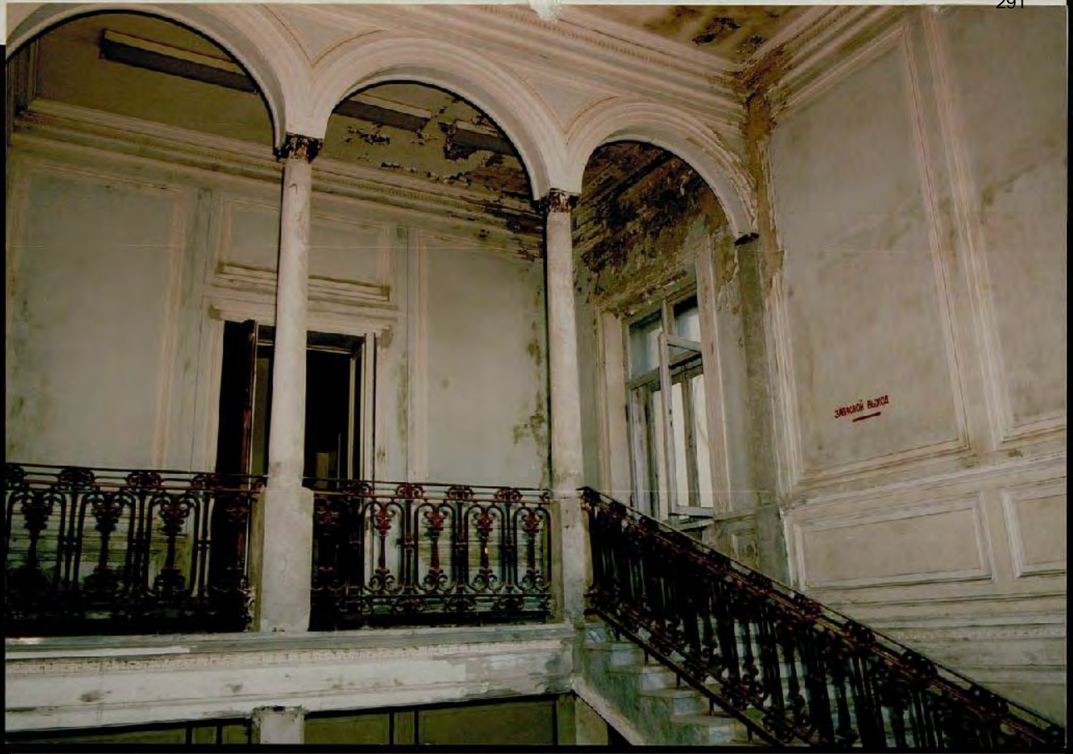
Санкт-Петербургское шоссе, 109 Дворцово-парковый ансамбль Михайловской дачи (Михайловки) XVIII в., 1834-1855; 1857-1864. Фото 17. Большой дворец. Парадная лестница. Верхняя площадка.
