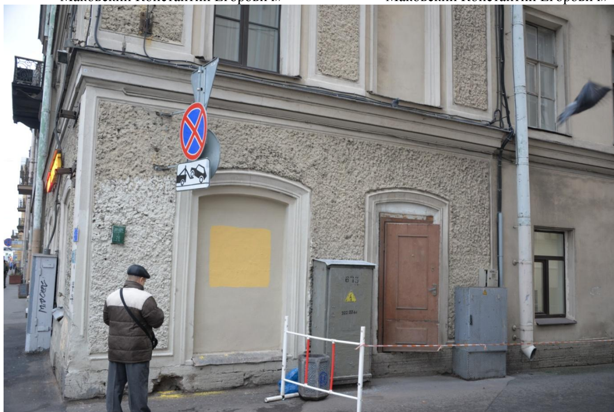
5. Фрагмент фасада объекта культурного наследия регионального значения «Дом, в котором жил в 1909-1915 гг. Маковский Константин Егорович»
