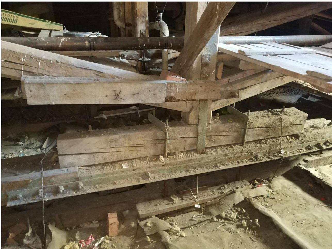
17. Выявленный объект культурного наследия «Дом Ш.З. Иоффа с кинематографом» по адресу: г.Санкт-Петербург, Лермонтовский проспект, дом 14, литера А Стропильные фермы покрытия Дата съемки: 02 ноября 2020 г.
