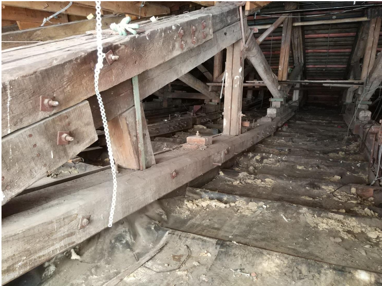
13. Выявленный объект культурного наследия «Дом Ш.З. Иоффа с кинематографом» по адресу: г.Санкт-Петербург, Лермонтовский проспект, дом 14, литера А Стропильные фермы покрытия Дата съемки: 02 ноября 2020 г.
