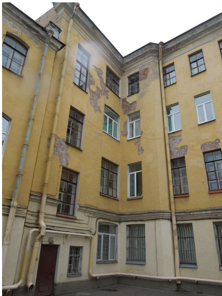
14. Объект культурного наследия регионального значения «Академия Михайловская артиллерийская, где преподавали ученые Ленц Э.Х., Остроградский М.В., Петрушевский В.Ф.» по адресу: Санкт-Петербург, улица Комсомола, дом 22, литера А. Дворовый фасад здания. Фрагмент. Оконные заполнения (деревянные, металлопластиковые).
