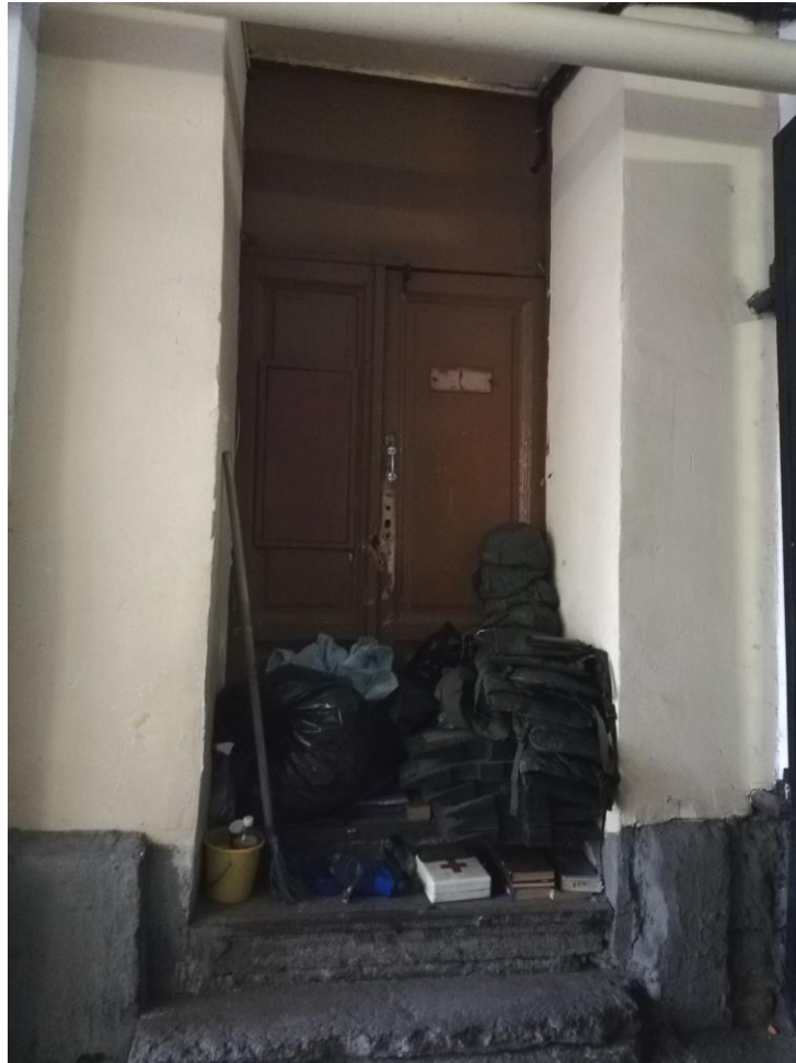
16. Объект культурного наследия регионального значения «Академия Михайловская артиллерийская, где преподавали ученые Ленц Э.Х., Остроградский М.В., Петрушевский В.Ф.» по адресу: Санкт-Петербург, улица Комсомола, дом 22, литера А. Дверной проем со стороны въездного проезда с деревянным филленчатым двустворчатым заполнением.
