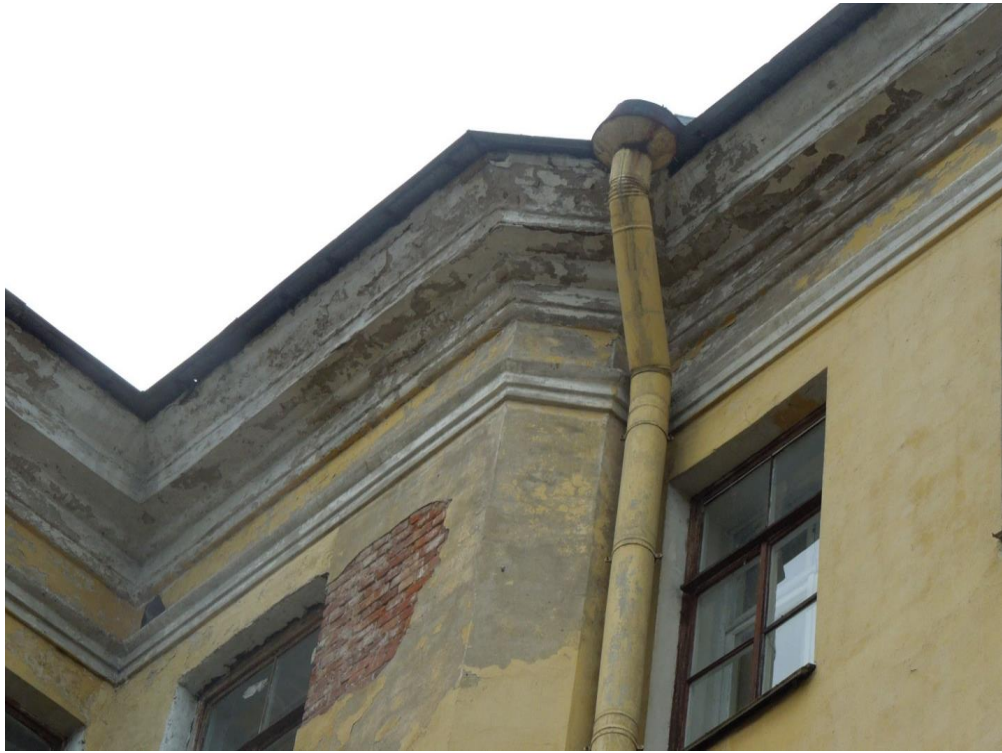
17. Объект культурного наследия регионального значения «Академия Михайловская артиллерийская, где преподавали ученые Ленц Э.Х., Остроградский М.В., Петрушевский В.Ф.» по адресу: Санкт-Петербург, улица Комсомола, дом 22, литера А. Дворовый фасад. Венчающий карниз. Фрагмент.
