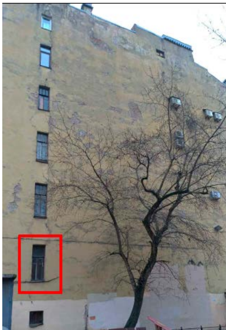
3. Оконное заполнение кв. №2 в уровне 2-го этажа дворового фасада объекта культурного наследия регионального значения «Дом Т.П. Павловой». 30.12.2020.
