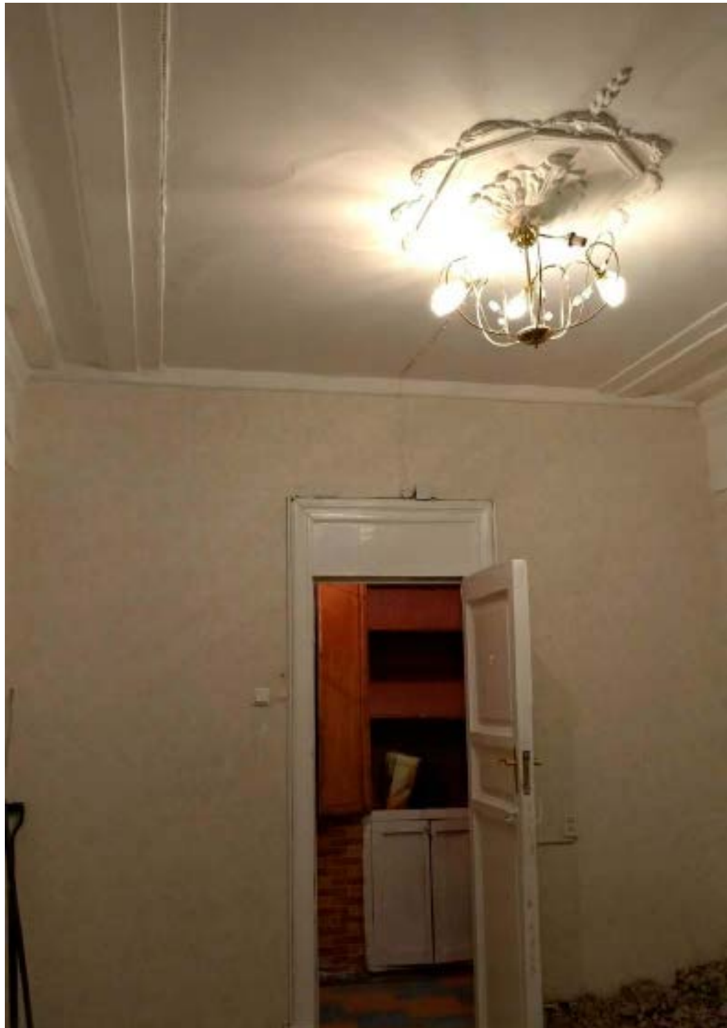
12. Помещение №3 кв. №2 в уровне 2-го этажа объекта культурного наследия регионального значения «Дом Т.П. Павловой», расположенного по адресу: г. Санкт-Петербург, Конная ул., д. 8, литера А. 30.12.2020.
