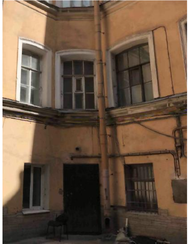
9. Дворец Великого князя Николая Николаевича (Ксенинский институт): Корпус для прислуги (пл. Труда, д. 4, лит. А.). Фото мест проектируемого прохождения кабельных трасс. 01.10.2020. Штиглиц М.С.
