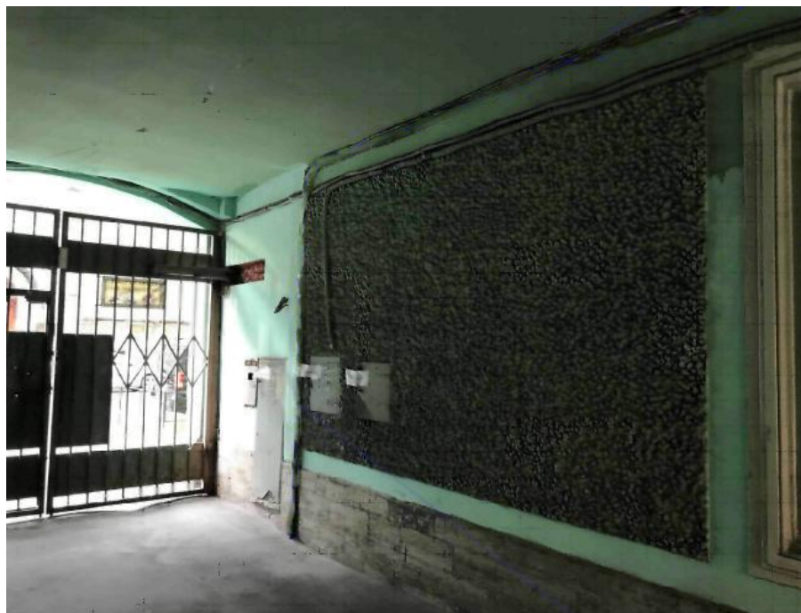
22. Дом А.П.Козлова (Большая Морская ул., д. 56, лит. А.). Фото мест проектируемого прохождения кабельных трасс. 01.10.2020. Штиглиц М.С.
