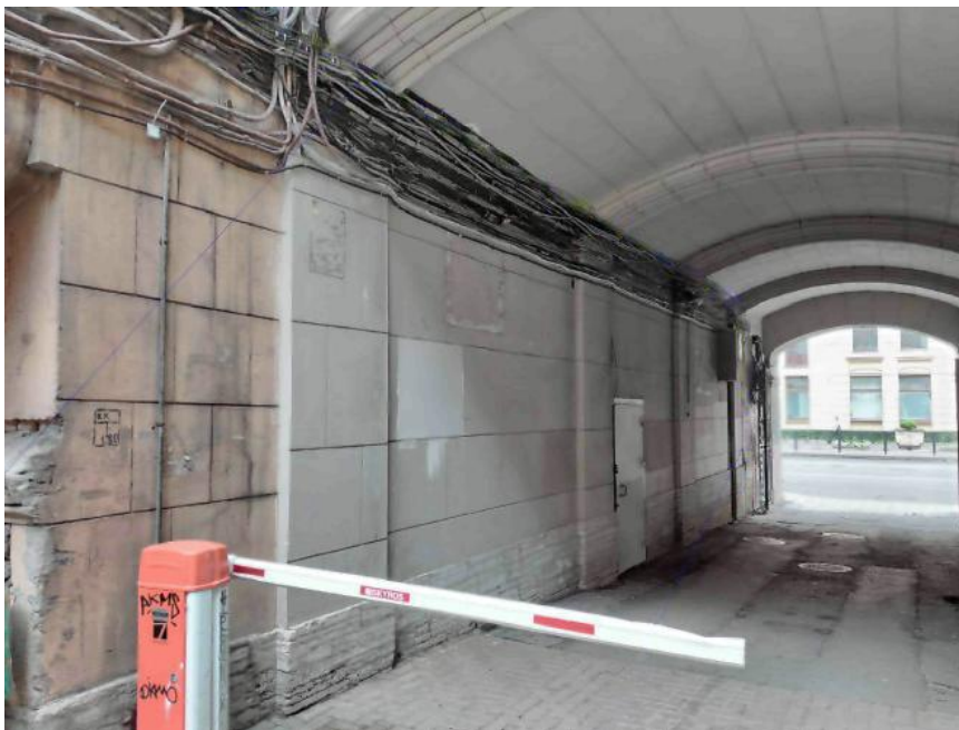
33. Дом городских учреждений (Садовая ул., д. 55-57, лит. А.). Фото мест проектируемого прохождения кабельных трасс. 01.10.2020. Штиглиц М.С.
