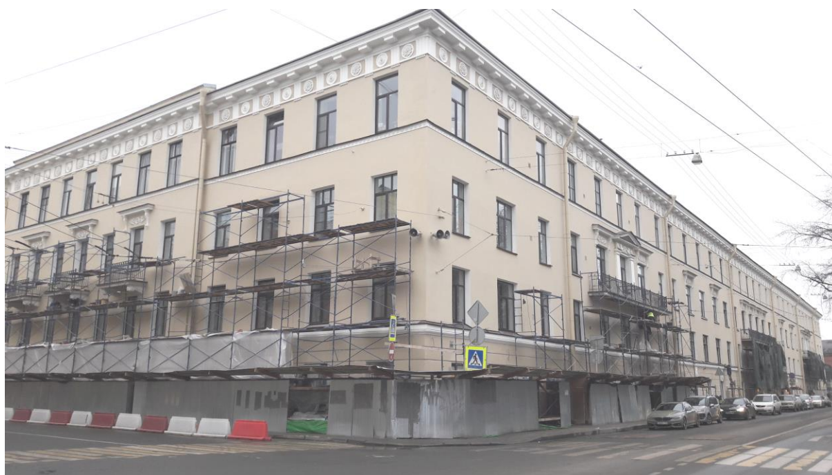
32. Квартира, в которой жил композитор и музыковед Асафьев Борис Владимирович в 1933-1943 гг. (Конногвардейский бульвар, д. 6, лит. А). 01.10.2020. Штиглиц М.С.
