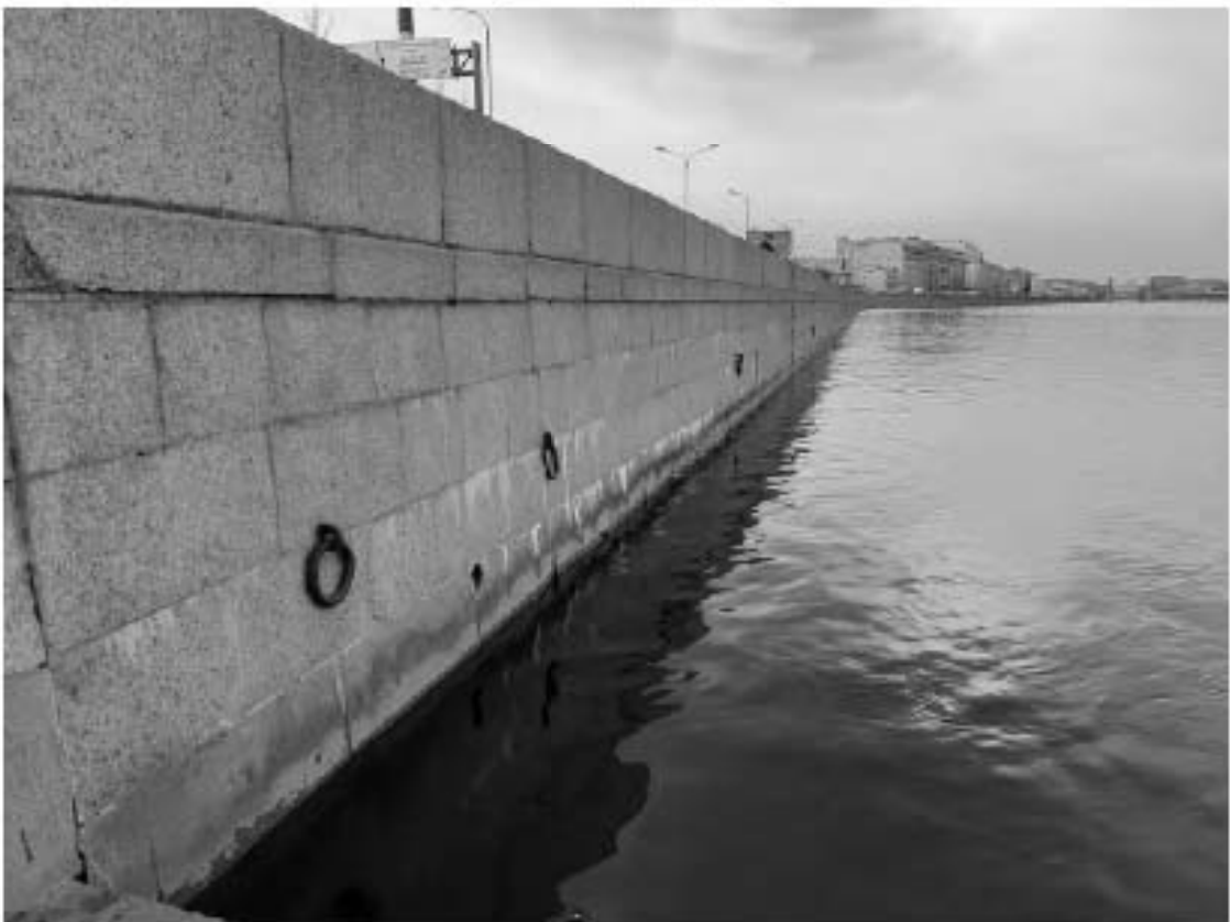
Рисунок 5.4 - Синопская набережная в районе объекта изысканий с метками высоких вод в виде полосы окисления на гранитных плитах облицовки.
