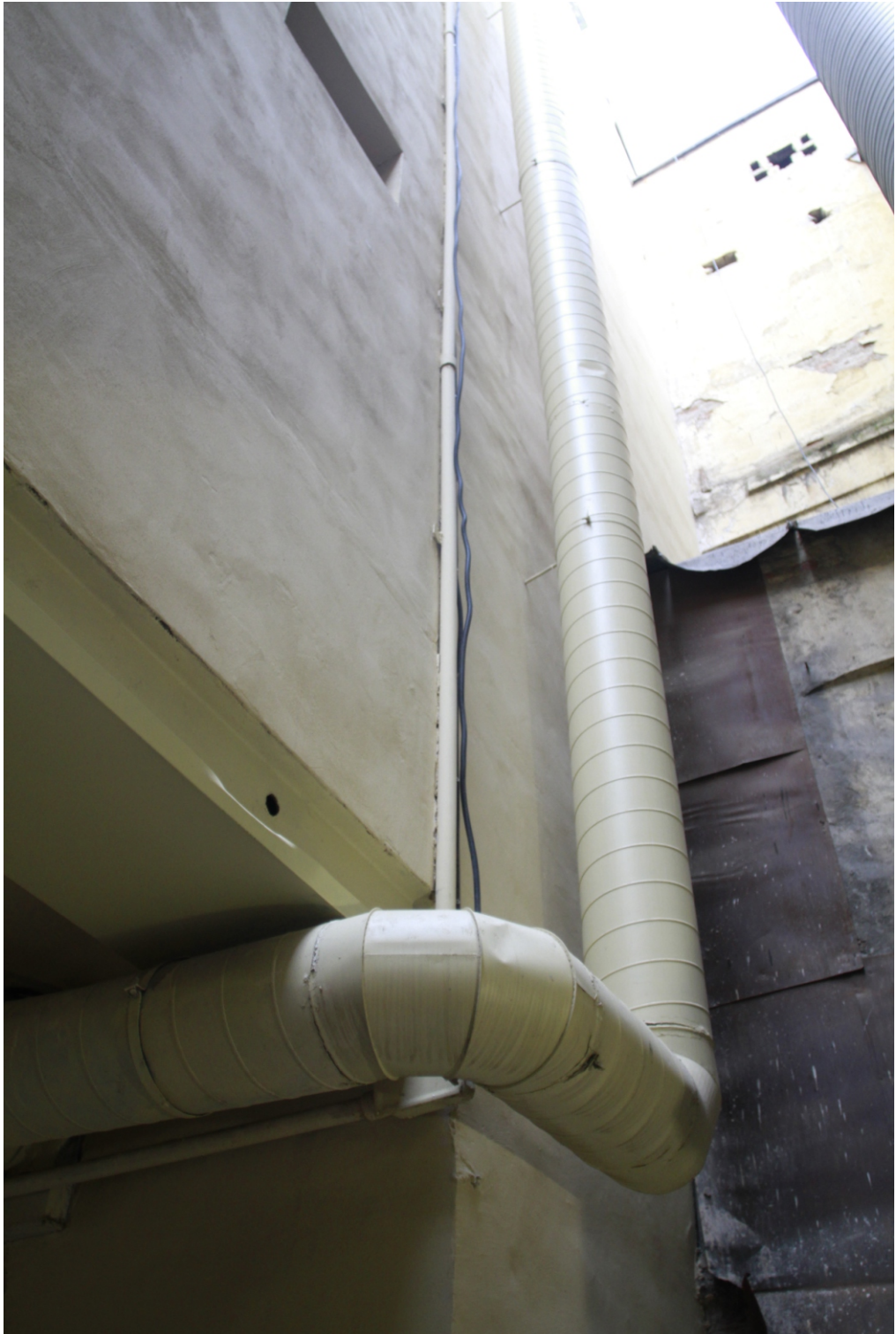
14. «Дом И.Д. Черткова». Санкт-Петербург, ул. Гороховая, д.24/24, литера А. Световой двор. Воздуховод. Фото: 15.11.2020.
