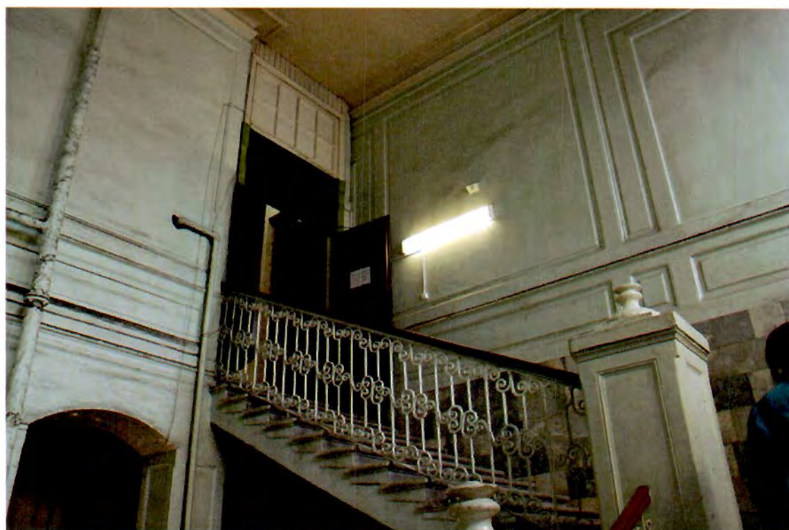
Фото №26. Литера А1. Пом. 35Н(V), Л-5.
