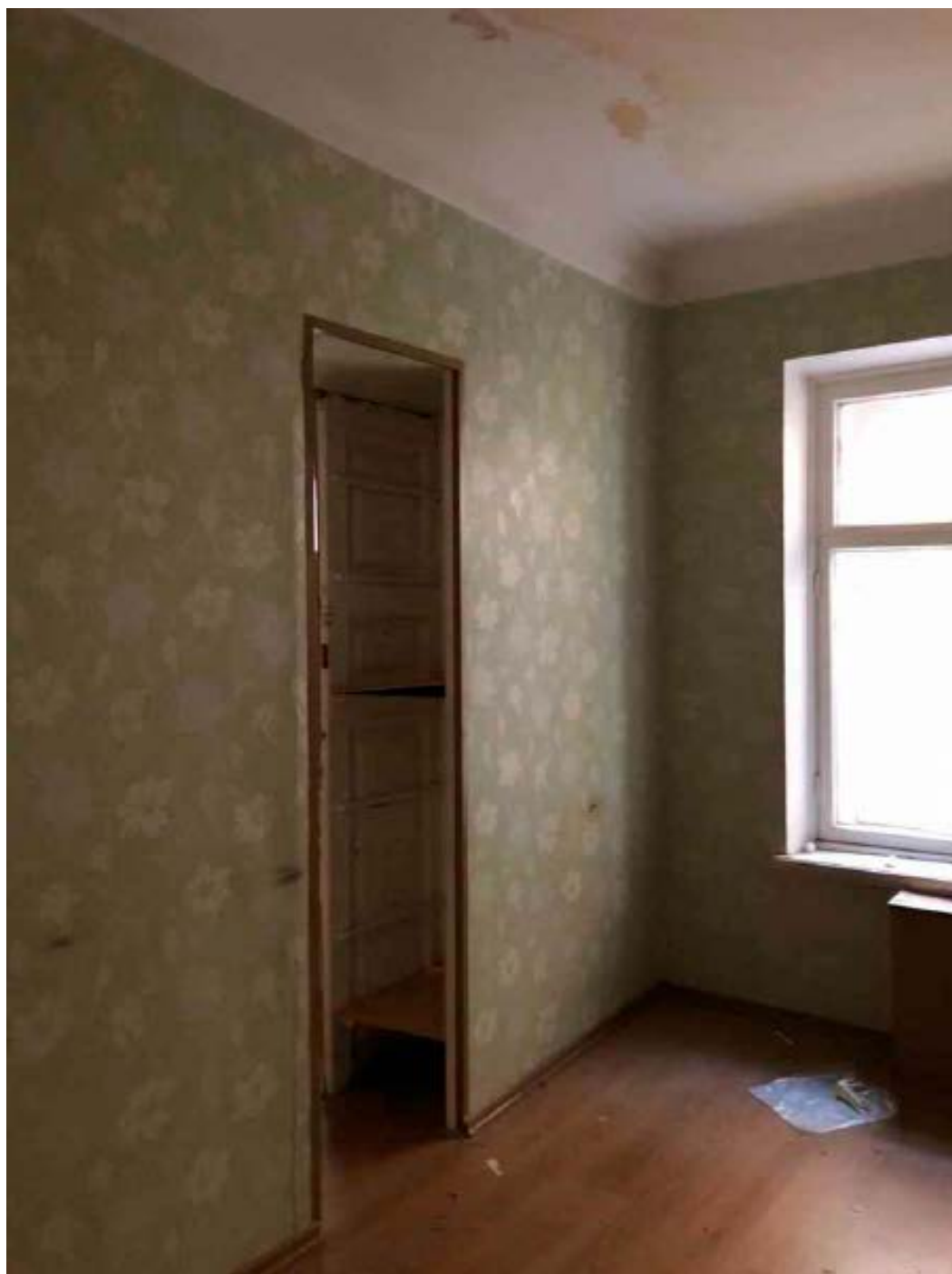
б. Помещение №8 кв. №11 в уровне 1-го этажа объекта культурного наследия регионального значения «Дом кн. Л.Д. Вяземского», расположенного по адресу: г. Санкт-Петербург, Галерная ул., д. 67, литера А. 15.12.2021.
