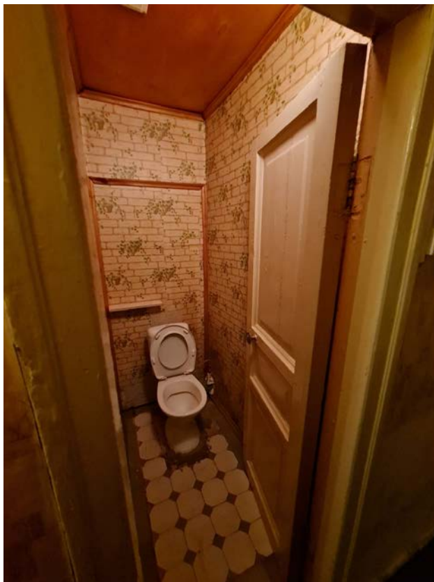
10. Выявленный объект культурного наследия «Дом М.Д. Усова» по адресу: г. Санкт-Петербург, ул. Смоленская, д. 1, лит. Д. Квартира 9 (помещение санузла)
