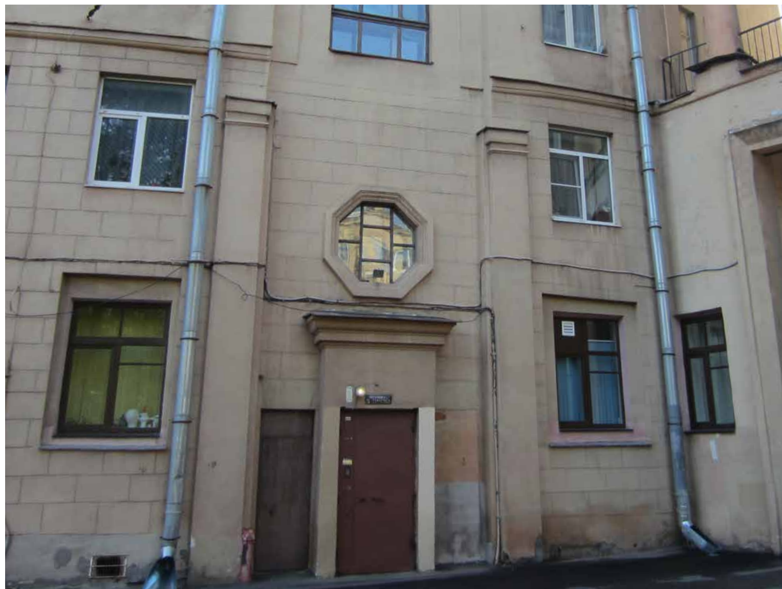
12. Объект культурного наследия регионального значения «Комплекс жилых домов (6 зданий)», расположенный по адресу: Санкт-Петербург, Красногвардейский район, Малоохтинский пр., 86, лит. А Фрагмент дворового фасада. Профилированный наличник восьмигранного окна, прямой сандрик над дверным проемом Съемка: 12 сентября 2019г.
