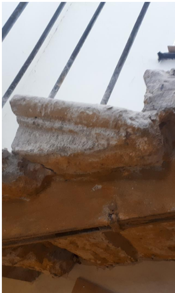
8. Служебная лестница. Состояние известняковых ступеней. Интерьер помещения 1-Н (часть помещения 13).
