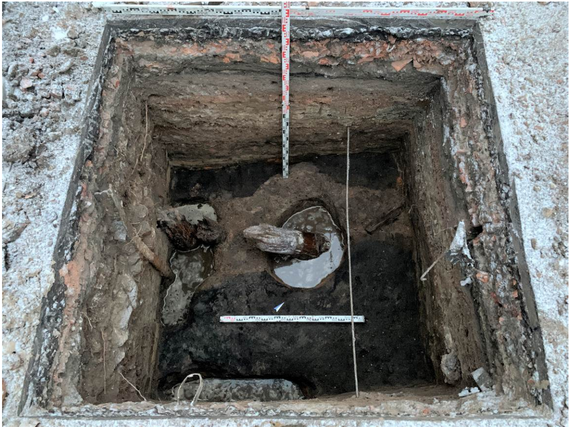
Рис. 40. Санкт-Петербург, Адмиралтейский район, ул. Марата, д. 92. Общий вид Шурфа 1. Промежуточная зачистка 5. Вид с СЗ.
