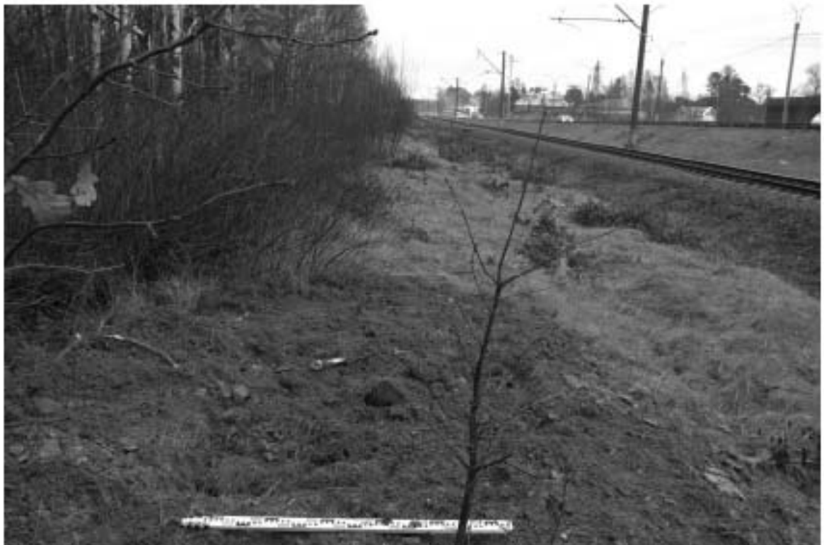
Рис. 65. г. Санкт-Петербург, Курортный район, Октябрьская железная дорога, Сестрорецкая линия. Шурф 10. Рекультивация. Вид с северо-запада.
