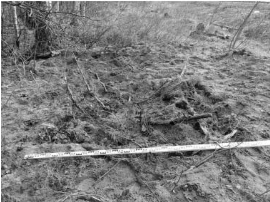
Рис. 77. г. Санкт-Петербург, Приморский район, Октябрьская железная дорога, Сестрорешская линия. Шурф 13. Рекультивация. Вид с северо-запада
