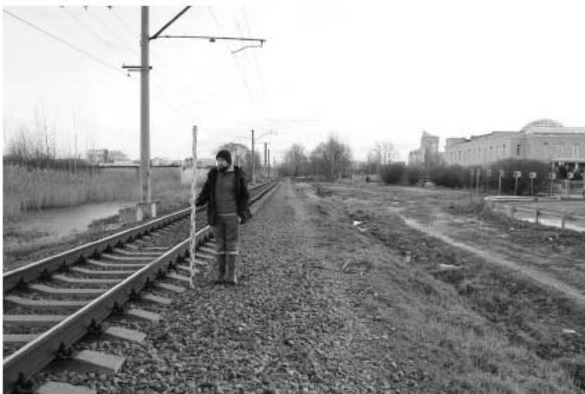
Рис. 29. г. Санкт-Петербург, Приморский район, Октябрьская ж.-д. Общий вид участка обследования в районе пересечения ул. Школьная и ул. Планерная. Вид с запада.
