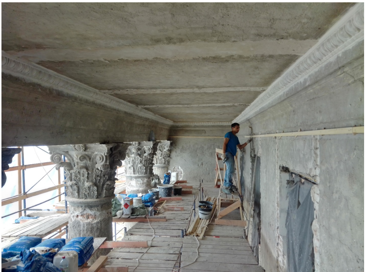
14. Юго-западный лицевой фасад выявленного объекта культурного наследия «Главный корпус с 1-м солдатским корпусом, офицерским флигелем и Михайловское артиллерийское училище», расположенного по адресу: г. Санкт-Петербург, ул. Комсомола, д. 22, литера А. 06.12.2021
