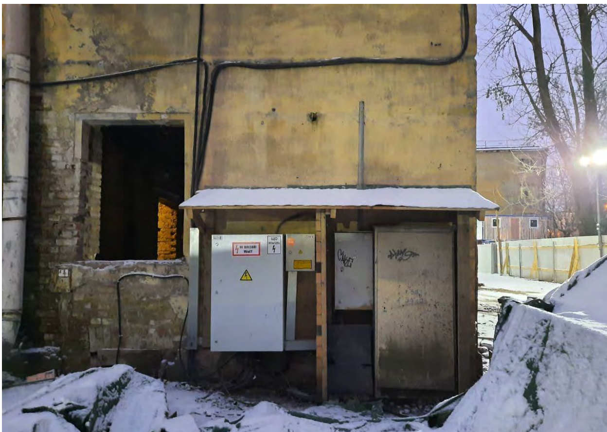
Фото 5.1. Корпус 4. Западный фасад. Вид на существующий кабельный киоск КК №930.
