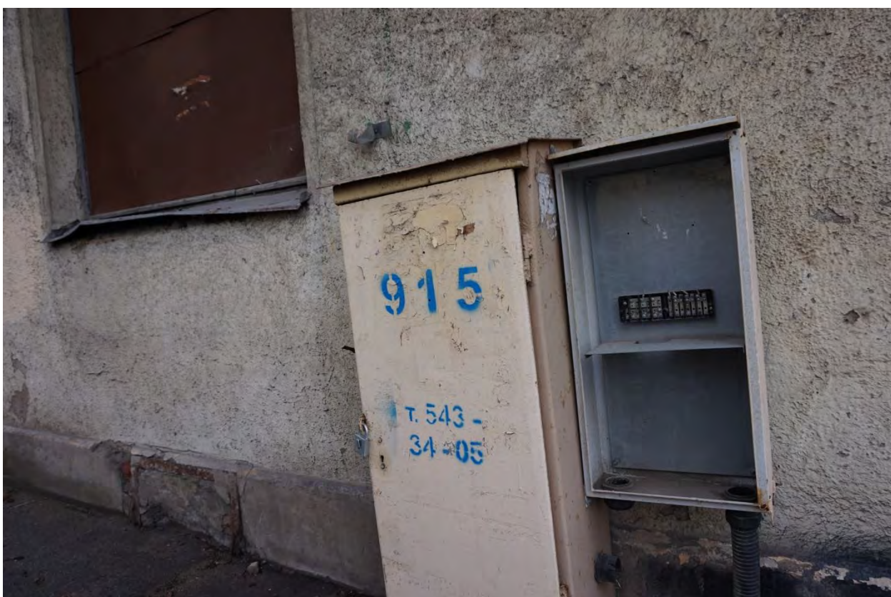
Фото 4.1. Корпус 3. Западный фасад. Вид на существующий кабельный киоск КК №915.
