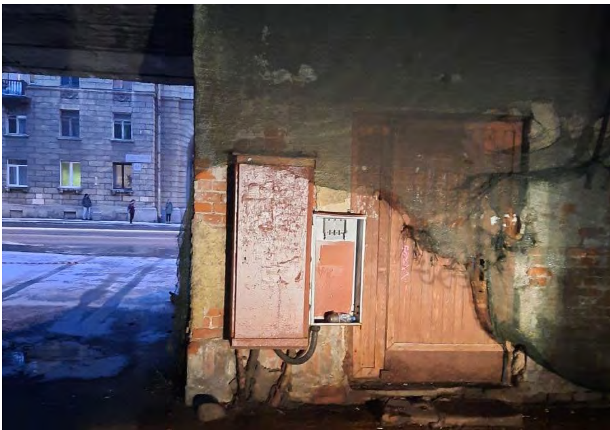
Фото 11.1. Корпус 11. Южный фасад. Вид на существующий кабельный киоск КК №4870.
