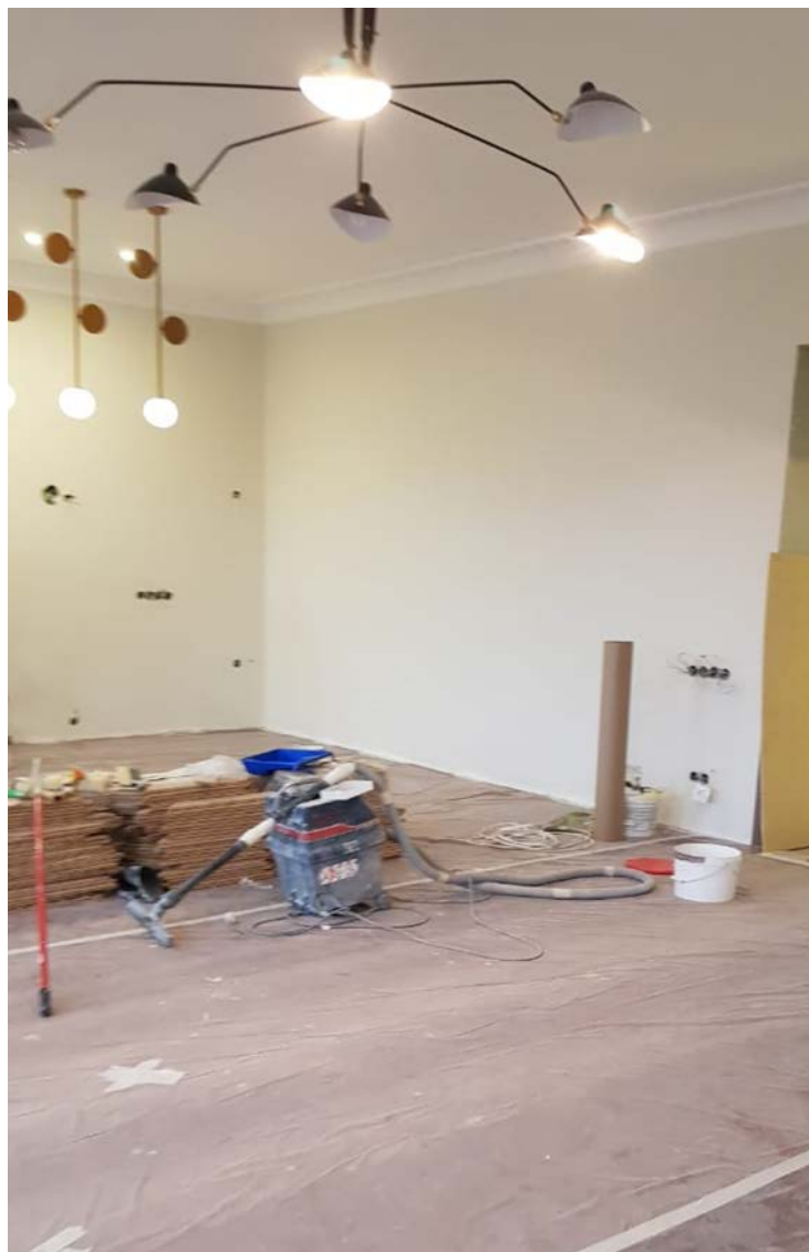
6. Помещение №2 кв. №8 в уровне 3-го этажа выявленного объекта культурного наследия «Дом В.А. Квасникова», расположенного по адресу: г. Санкт-Петербург, 7-я линия В.О., д. 28, литера А. 15.09.2020.
