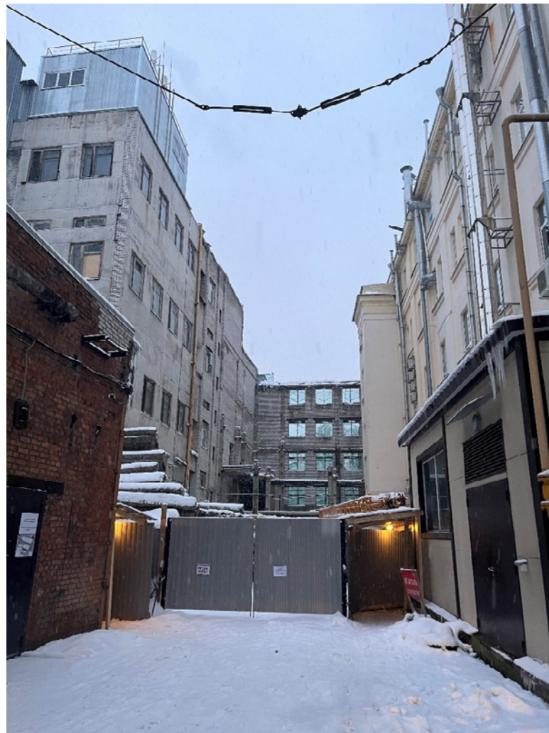
Фото №8. Дворовый фасад здания по пр. Медиков, д. 7, лит. Ж (объекта незавершенного строительства), место примыкания к соседнему зданию по ул. Профессора Попова.
