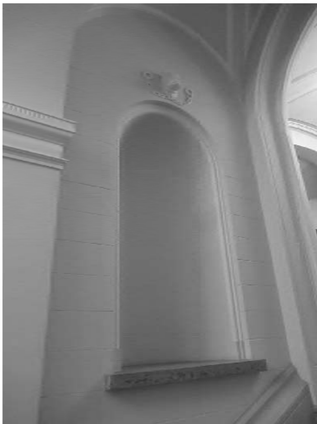
9. ОКН "Усадьба Военного министра", расположенный по адресу: г. Санкт-Петербург, ул. Садовая, д. 4, лит. А. Особняк. Вестибюль. Нижний уровень. Дата фотофиксации: 17.11.2021
