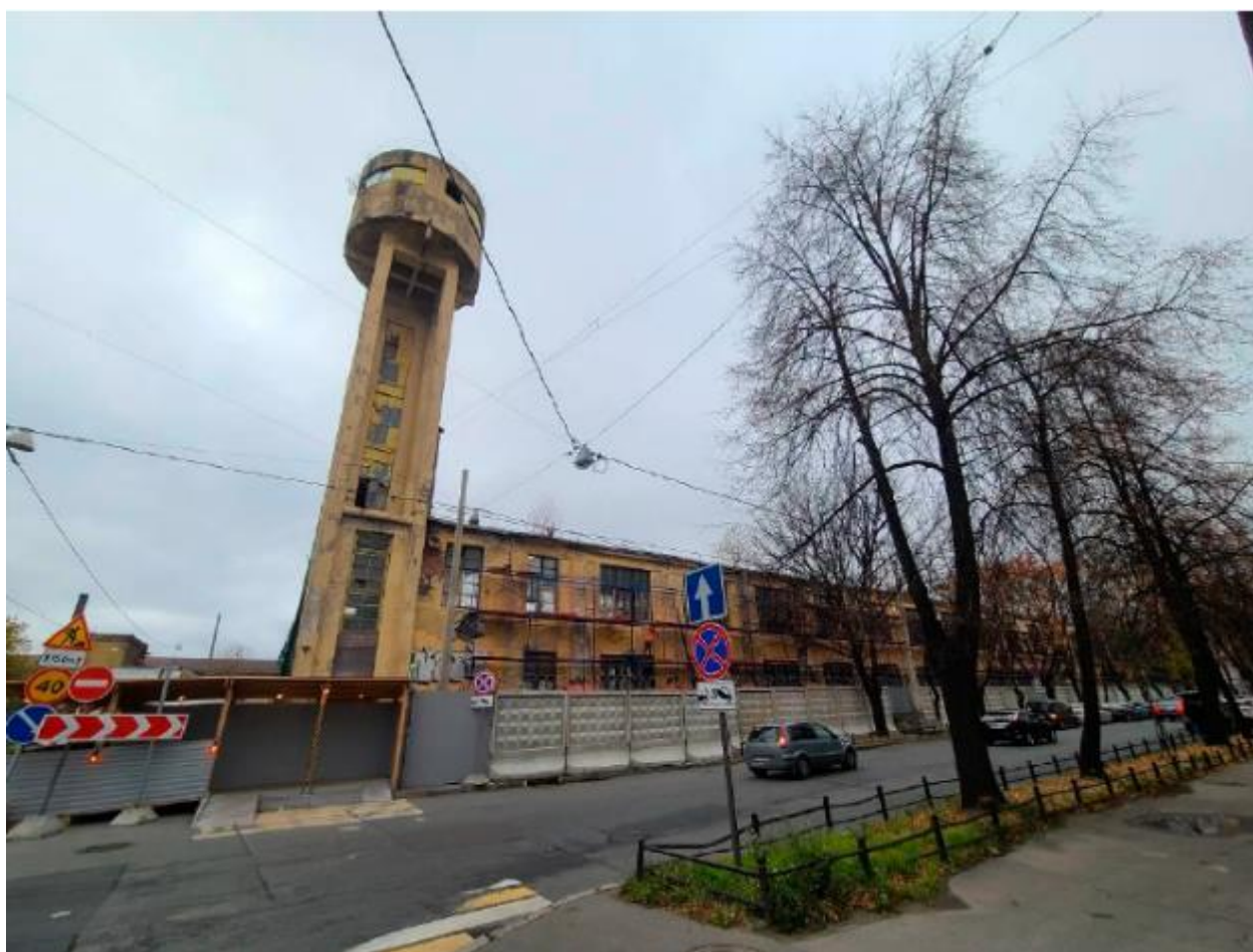
2. Северо-восточный фасад объекта культурного наследия регионального значения «Канатный цех с водонапорной башней завода «Красный гвоздильщик» по адресу: г. Санкт-Петербург, 25-я линия В.О., д. 6, корп. 1, литера Б. 25.10.2021
