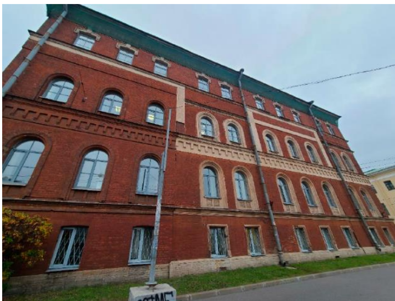
7. Северо-восточный фасад выявленного объекта культурного наследия «Здание Главной Геофизической обсерватории при Горном институте» по адресу: г. Санкт-Петербург, 23-я линия В.О., д. 2а, литера А. 25.10.2021
