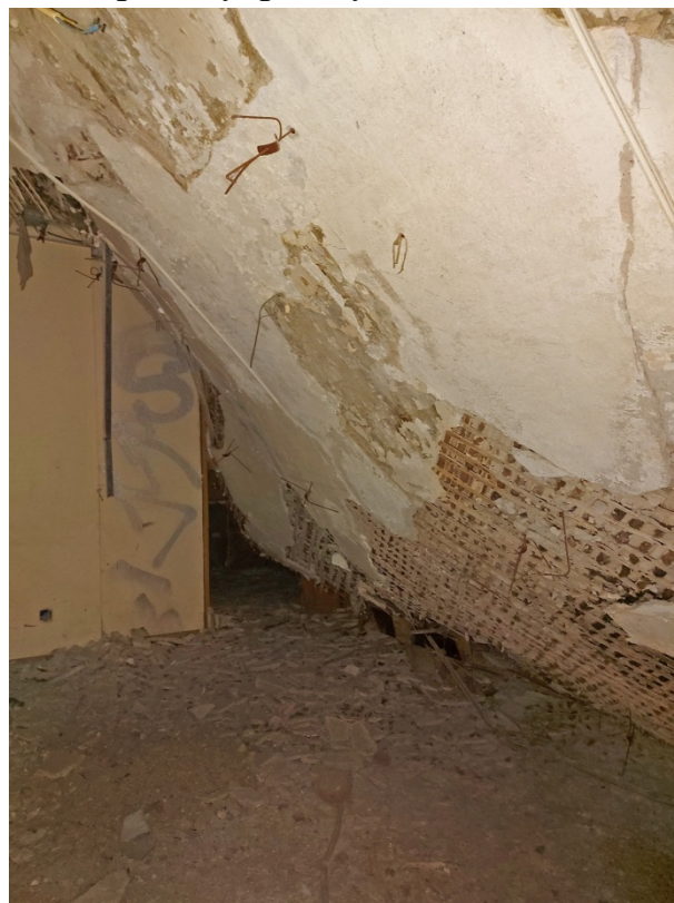
Фото 21. Помещение 20, обрушение перекрытия.
