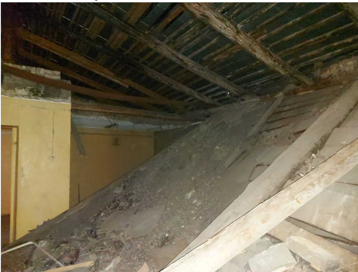
Фото 61. Обрушение перекрытия третьего этажа в пом.7.
