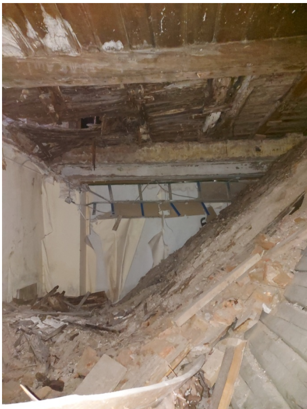
Фото 34. Помещение 20, разрушение перекрытия.
