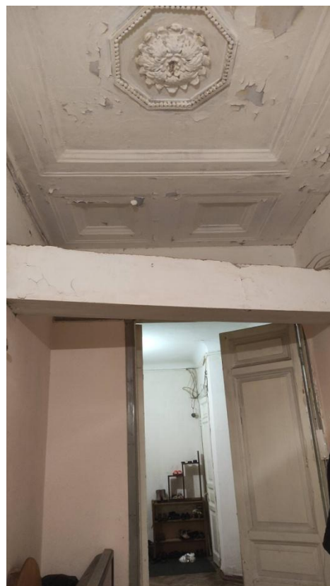
Фото 35. Интерьер квартиры №2, расположенной в выявленном объекте культурного наследия «Дом Т.М. Любищевой», ч.п.13, оформление потолка
