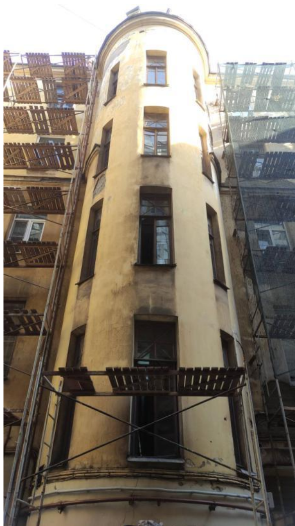
Фото 8. Фрагмент дворового фасада выявленного объекта культурного наследия «Дом Т.М. Любищевой», ризалит парадной лестничной клетки
