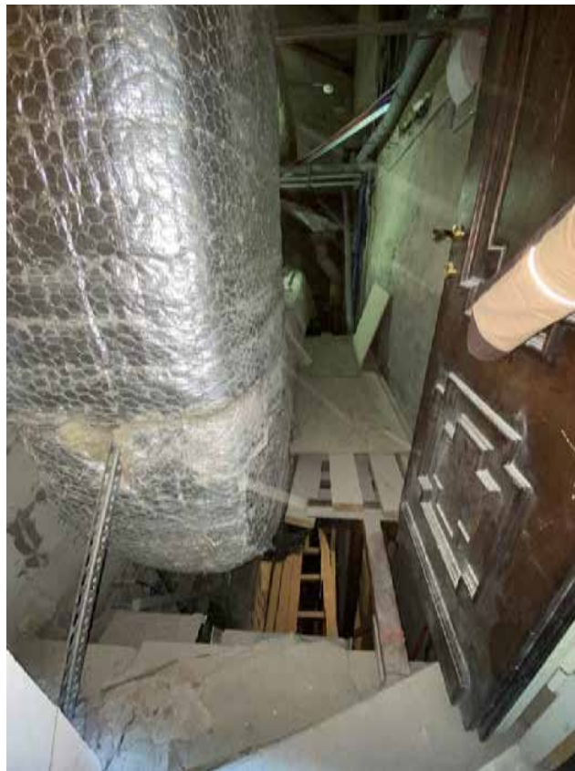
Фото 17. Помещение венткамеры. Вид с востока..
