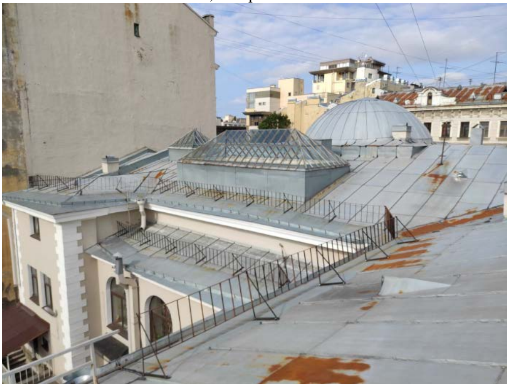
22. Световой фонарь и кровля объекта культурного наследия регионального значения «Быв. дом Белозерского», расположенного по адресу: г. Санкт-Петербург, ул. Куйбышева, д. 25, литера А. 15.10.2021.
