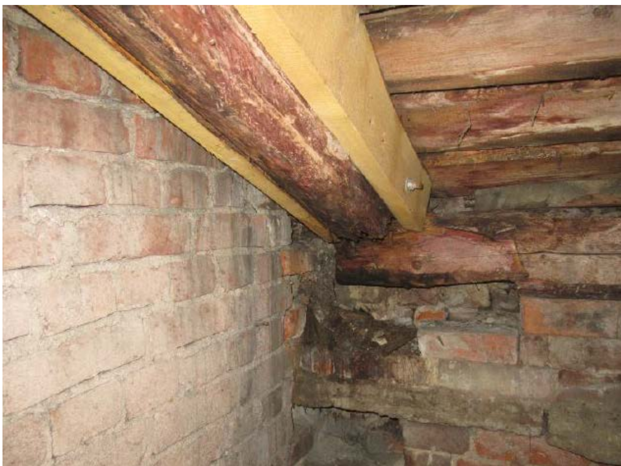
9. Обрешетка и кровля объекта культурного наследия регионального значения «Быв. дом Белозерского», расположенного по адресу: г. Санкт-Петербург, ул. Куйбышева, д. 25, литера А. 15.10.2021.
