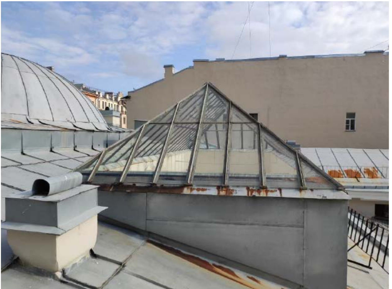
21. Световой фонарь объекта культурного наследия регионального значения «Быв. дом Белозерского», расположенного по адресу: г. Санкт-Петербург, ул. Куйбышева, д. 25, литера А. 15.10.2021.
