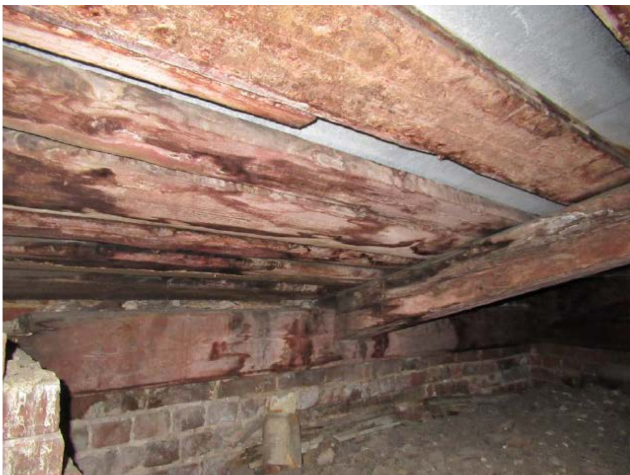
15. Стропильная система объекта культурного наследия регионального значения «Быв. дом Белозерского», расположенного по адресу: г. Санкт-Петербург, ул. Куйбышева, д. 25, литера А. 15.10.2021.
