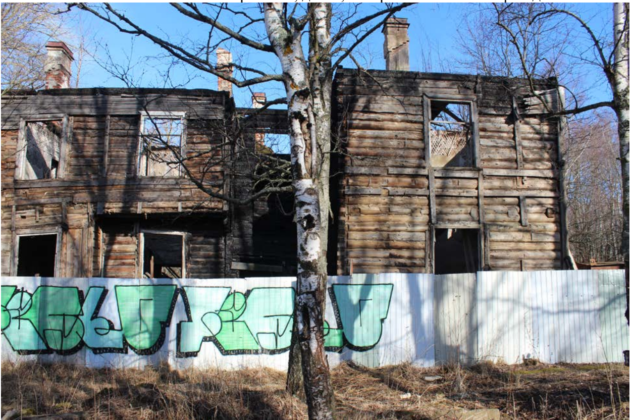
12. Объект культурного наследия «Усадьба Ю.И. Жерар-де-Суконтон (главный дом с территорией)», расположенный по адресу: Санкт-Петербург, город Петергоф, Собственный проспект, дом 4, литера А. Южный фасад.
