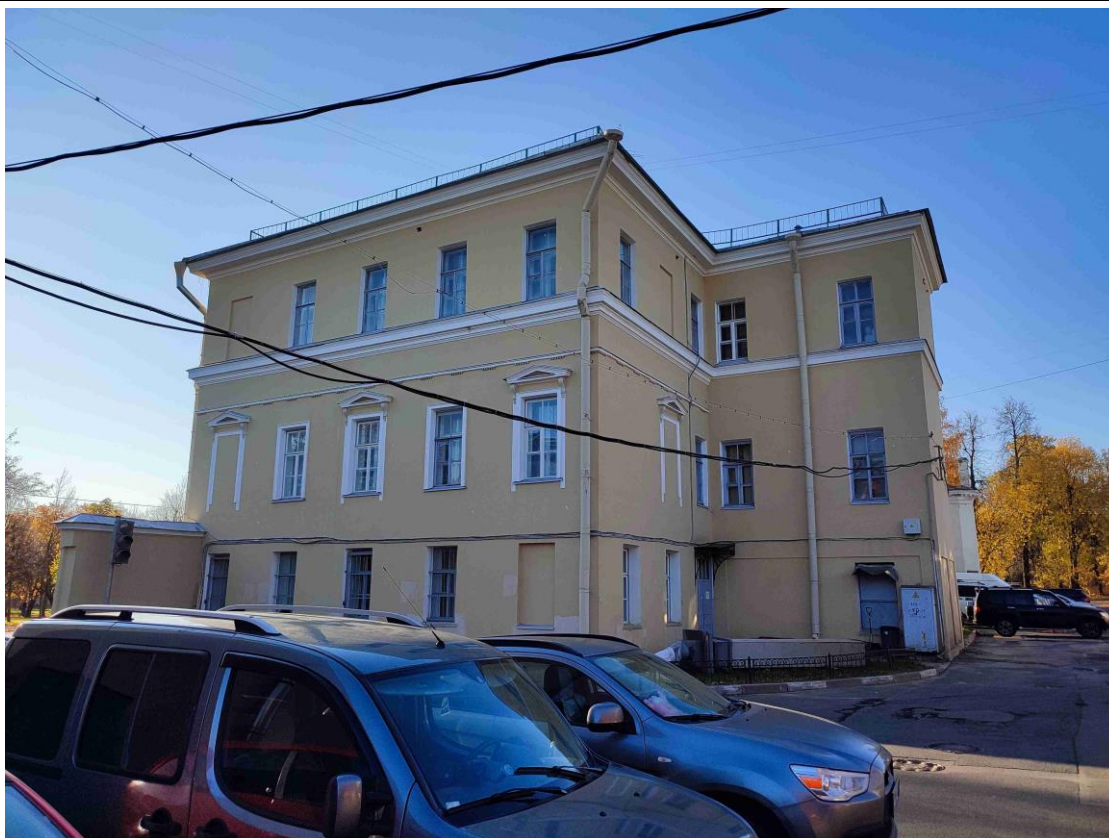
5. Общий вид северо-восточного торцевого фасада объекта культурного наследия федерального значения «Управление городское с оградой и воротами».
