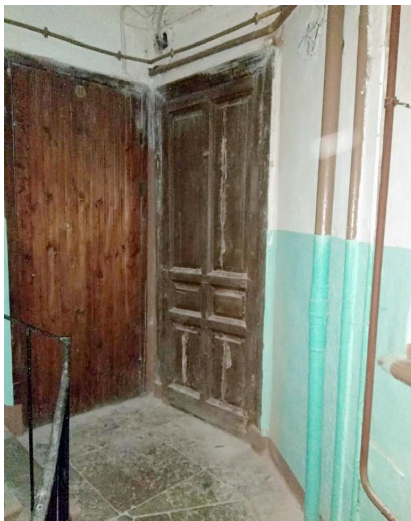
Фото 15. «Черная» лестница входа со двора. Лестничная площадка 1-го этажа. Справа – дверь в кв. №10.
