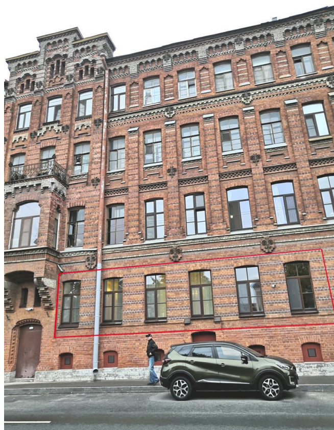
Фото 5. Фрагмент лицевого (южного) фасада по наб. р. Фонтанки. Справа – обозначены окна квартиры №10. Вид с юга.
