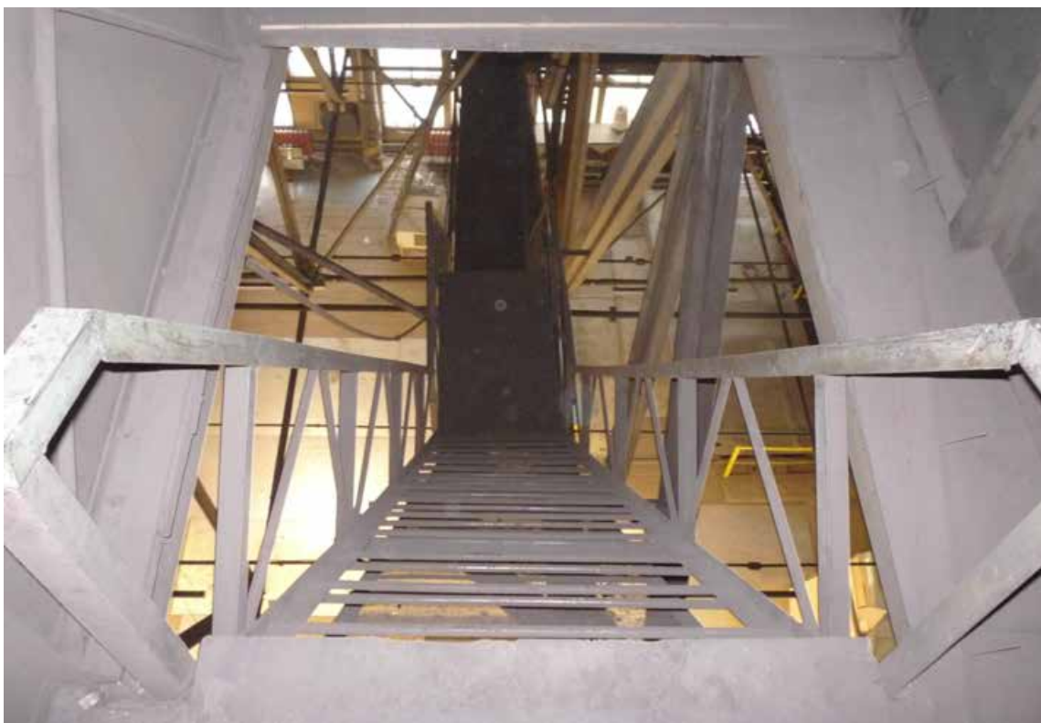
37. Выявленный объект культурного наследия «Разбивочный плаз». Конструкции кровли. Лестница в фотопроеекционную. Вид сверху. Съёмка 23 марта 2021 г.
