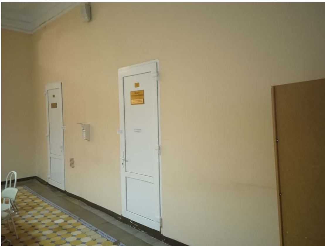
13. Помещение № 17 первого этажа (приемный покой). Северо-западная стена помещения в зоне прогиба балки.
