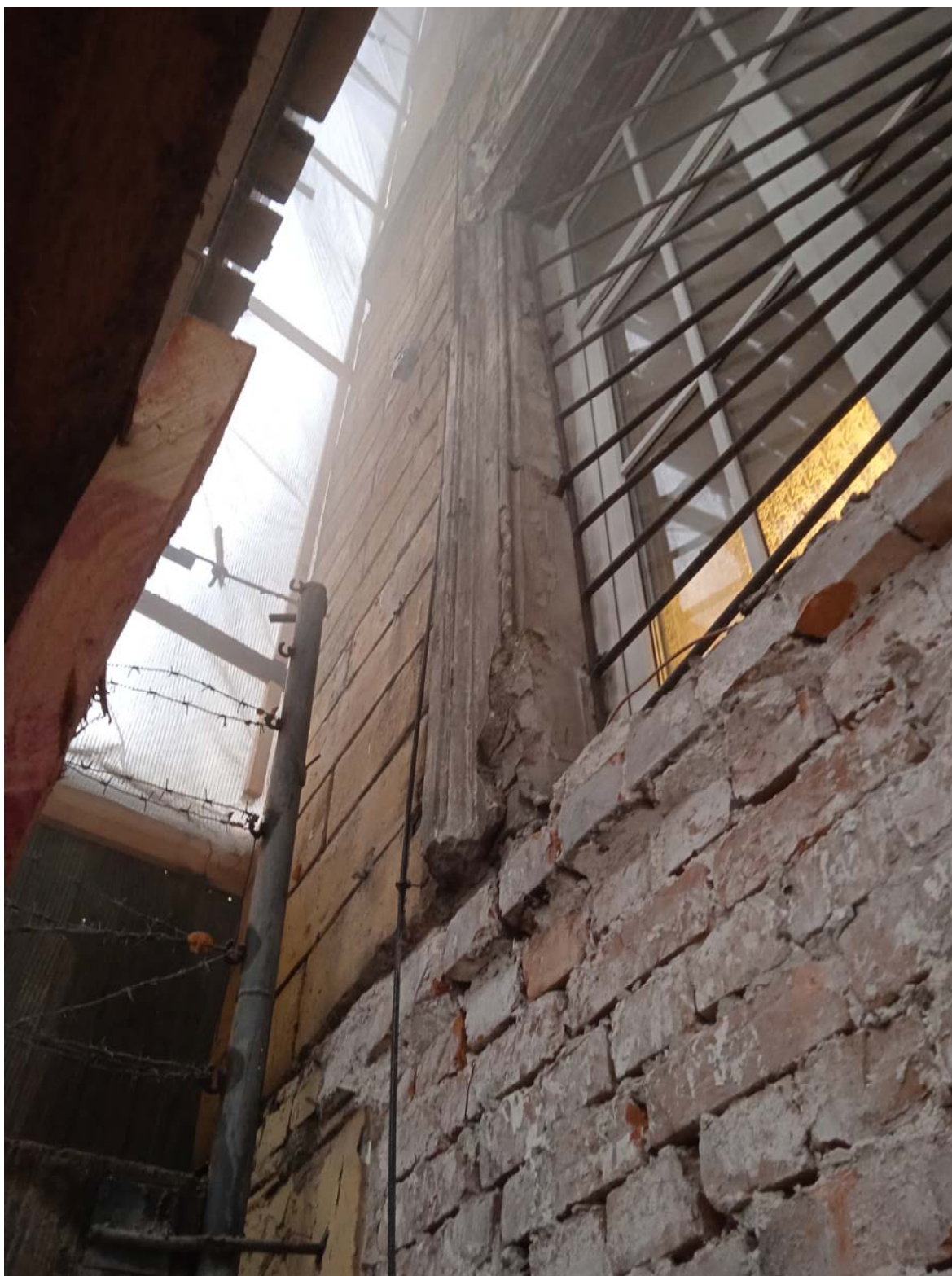
7. Юго-западный фасад здания между осями 25-24/Д в уровне первого этажа. Деструкция кирпичной кладки, утраты шовного раствора. Вертикальная сквозная трещина в кладке
