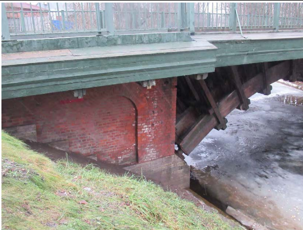
15. Объект культурного наследия регионального значения «Лаврский 2-ой мост» по адресу: г. Санкт-Петербург, через реку Монастырку по Лаврскому проезду. Вид на кирпичную опору (устой) и фрагмент конструкции из шести деревянных клееных арок. (Дата съемки 01.12.2020)
