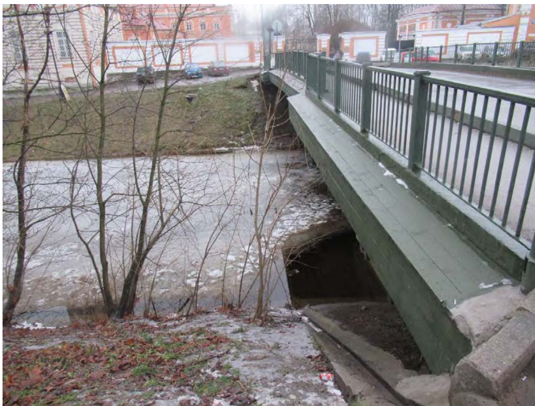
27. Объект культурного наследия регионального значения «Лаврский 2-ой мост» по адресу: г. Санкт-Петербург, через реку Монастырку по Лаврскому проезду. Вид на дощатый карниз верховой части моста от ограды Тихвинского кладбища. (Дата съемки 01.12.2020)
