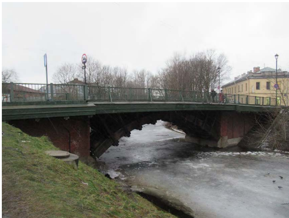
14. Объект культурного наследия регионального значения «Лаврский 2-ой мост» по адресу: г. Санкт-Петербург, через реку Монастырку по Лаврскому проезду. Вид на верховую часть моста и конструкцию из шести деревянных клееных арок. (Дата съемки 01.12.2020)
