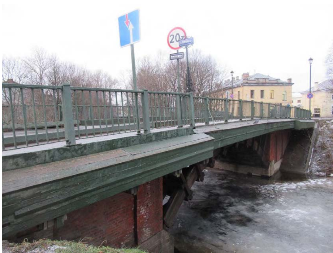
32. Объект культурного наследия регионального значения «Лаврский 2-ой мост» по адресу: г. Санкт-Петербург, через реку Монастырку по Лаврскому проезду. Вид на дощатый карниз верховой части моста от Северо-Западной башни (ризницы). (Дата съемки 01.12.2020)
