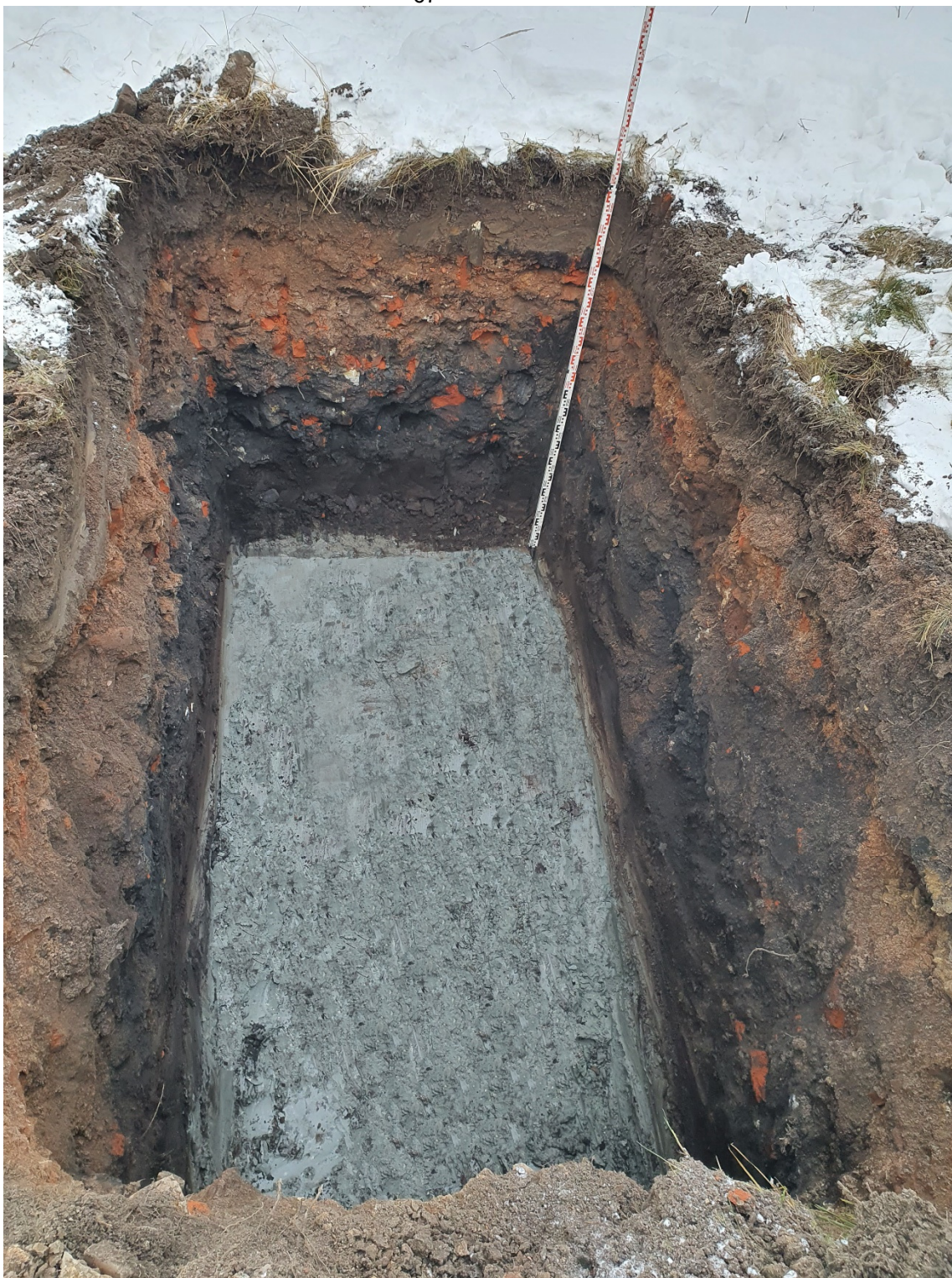
Рис. 19. СПБ – 2021. Московский район, Бассейная ул., д. 8. Шурф 1. Фиксация по уровню материковой поверхности. Вид с юга
