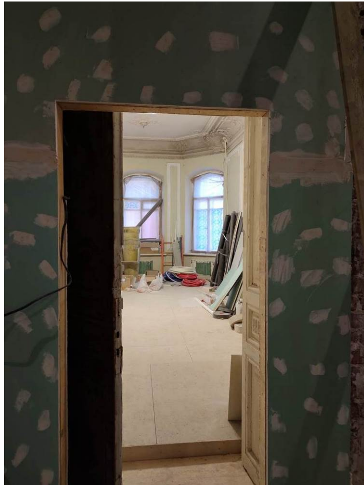
47. ОКН регионального значения «Жилой дом страхового общества “Россия” с садом и оградами» (г. Санкт-Петербург, Моховая ул., 27-29). Помещение кв.№ 70.
