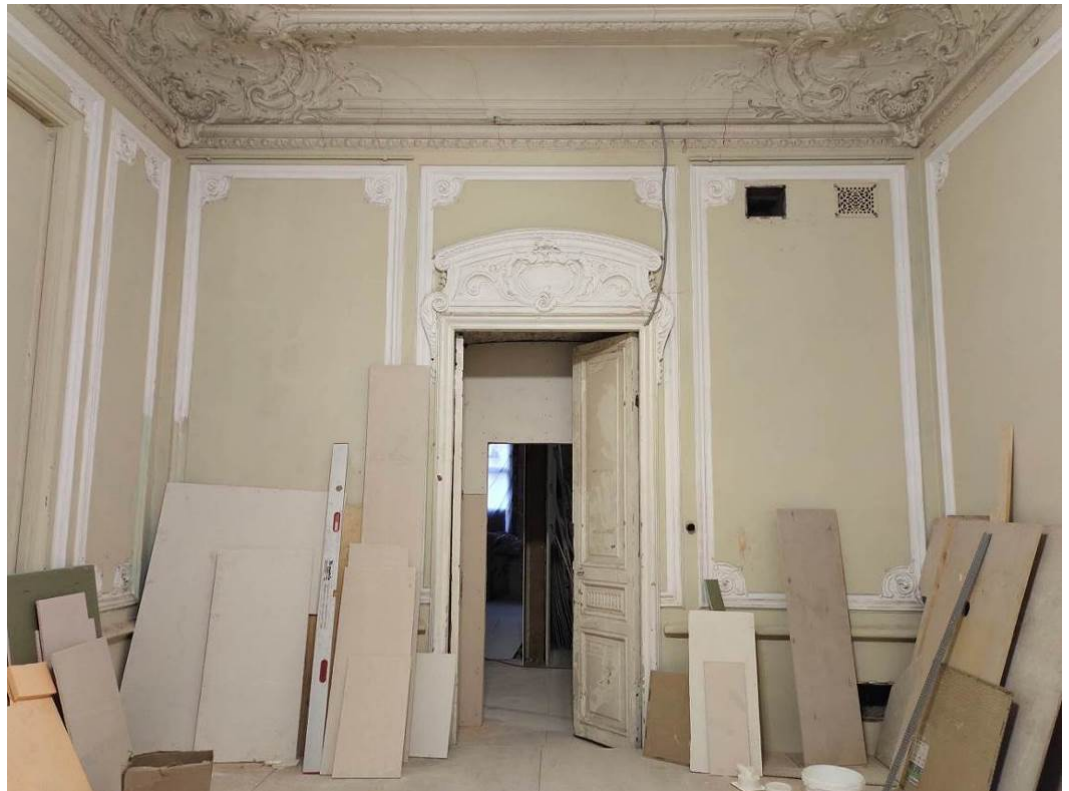
48. ОКН регионального значения «Жилой дом страхового общества “Россия” с садом и оградой» (г. Санкт-Петербург, Моховая ул., 27-29). Помещение кв.№ 70.
