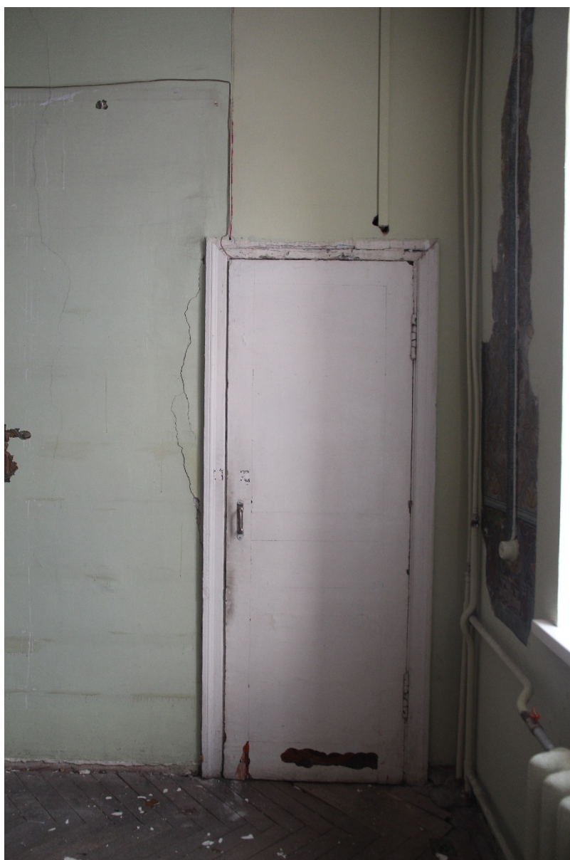
32. Санкт-Петербург, 3-я линия В.О., 30-32. Выявленный объект культурного наследия «Елизаветинская богадельня купцов Елисеевых». Второй этаж. Помещение 148 (54,2 кв.м). Оформление дверного проема. Дата фотофиксации: 02.12.2021 г.
