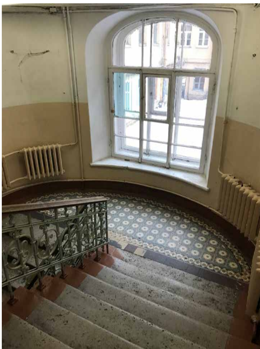
27. Санкт-Петербург, 3-я линия В.О., 30-32. Выявленный объект культурного наследия «Елизаветинская богадельня купцов Елисеевых». Помещение 5 (21,4 кв.м). Покрытие межлестничной площадки. Дата фотофиксации: 02.12.2021 г.
