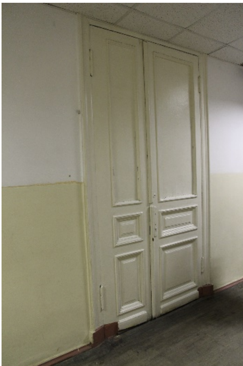
59. Санкт-Петербург, 3-я линия В.О., 30-32. Выявленный объект культурного наследия «Елизаветинская богадельня купцов Елисеевых». Третий этаж. Помещение 216 (41, 9 кв.м). Оформление дверного проема. Дата фотофиксации: 02.12.2021 г.
