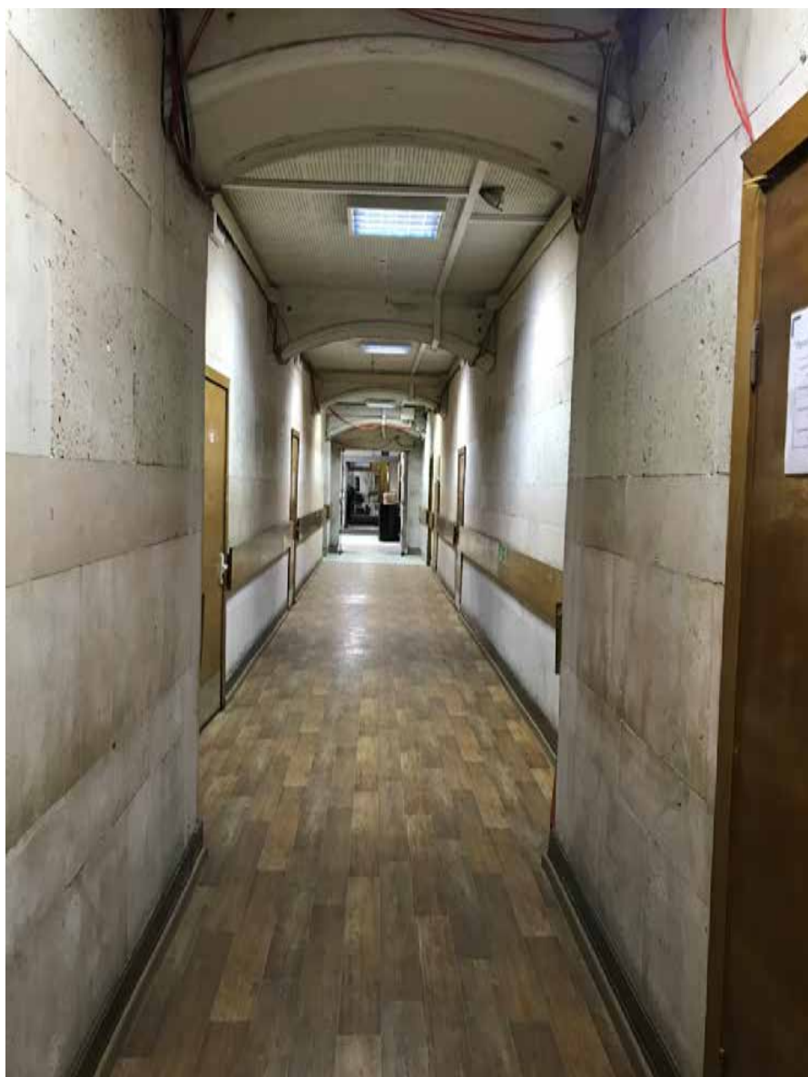
24. Санкт-Петербург, 3-я линия В.О., 30-32. Выявленный объект культурного наследия «Елизаветинская богадельня купцов Елисеевых». Первый этаж. Помещение 63 (32,2 кв.м). Дата фотофиксации: 02.12.2021 г.
