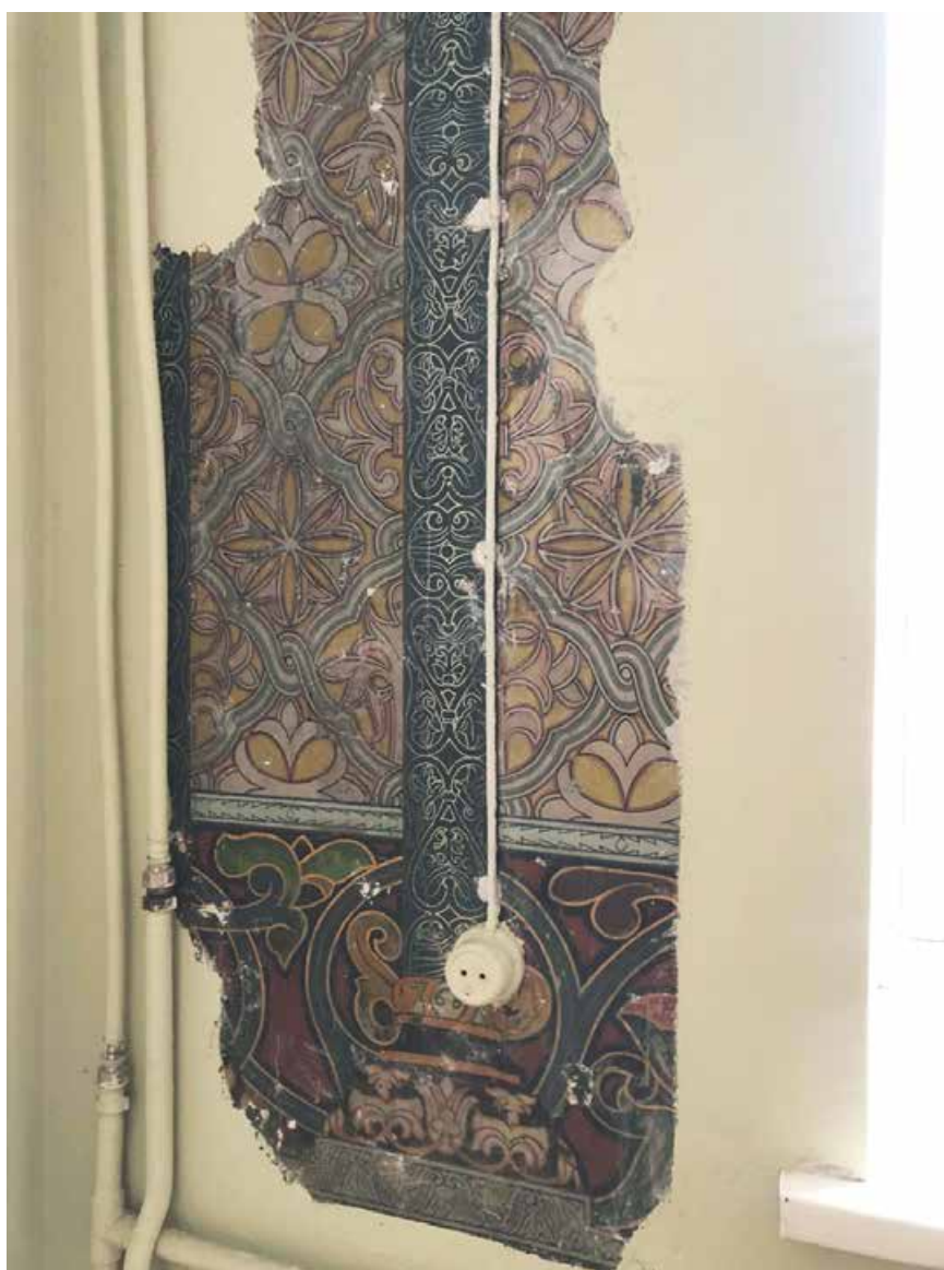
37. Санкт-Петербург, 3-я линия В.О., 30-32. Выявленный объект культурного наследия «Елизаветинская богадельня купцов Елисеевых». Второй этаж. Помещение 148 (54,2 кв.м). Фрагмент настенной росписи. Дата фотофиксации: 02.12.2021 г.
