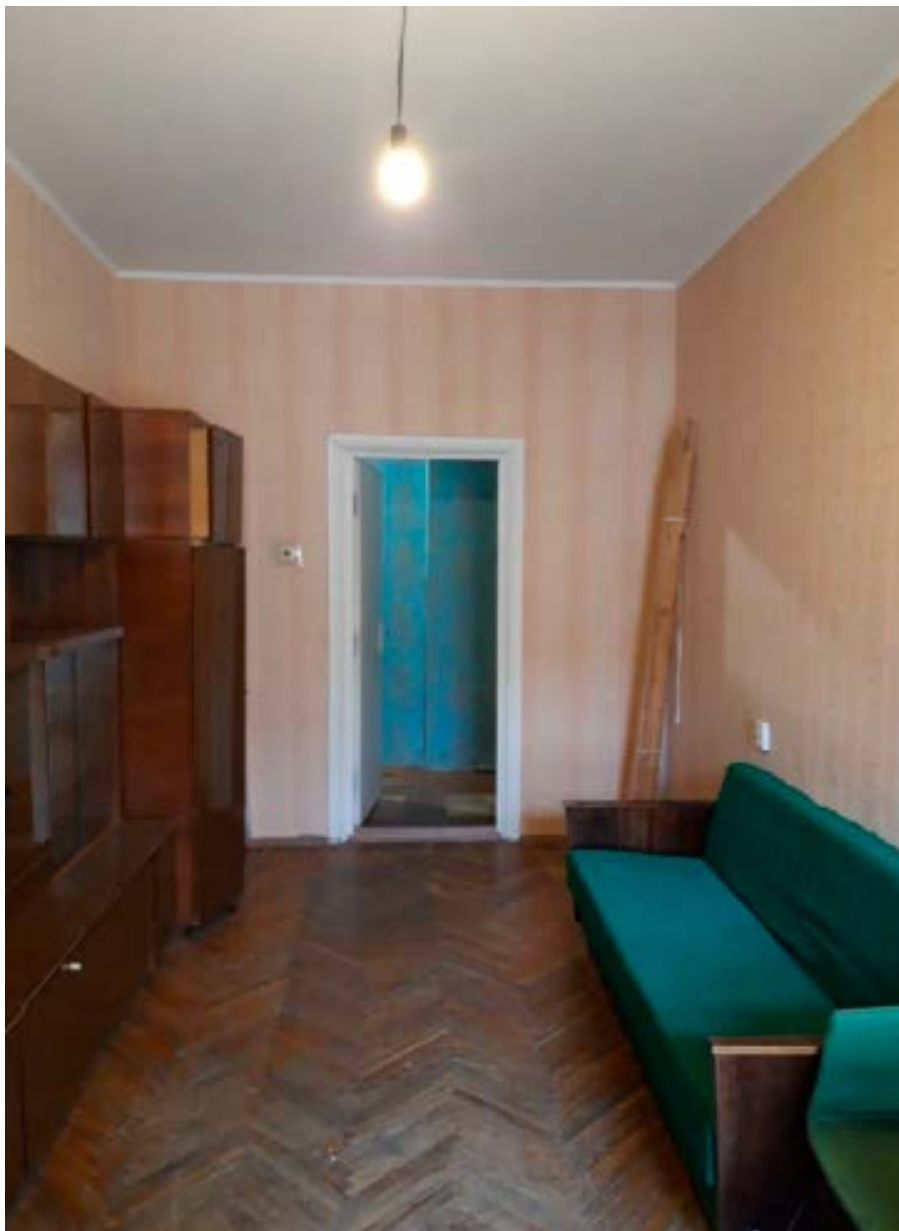
7. Помещение №4 кв. №10 в уровне 5-го этажа объекта культурного наследия регионального значения «Дом П.Д. Мальцова», расположенного по адресу: г. Санкт-Петербург, Пушкинская ул., д. 2/79, литера А. 01.06.2021.
