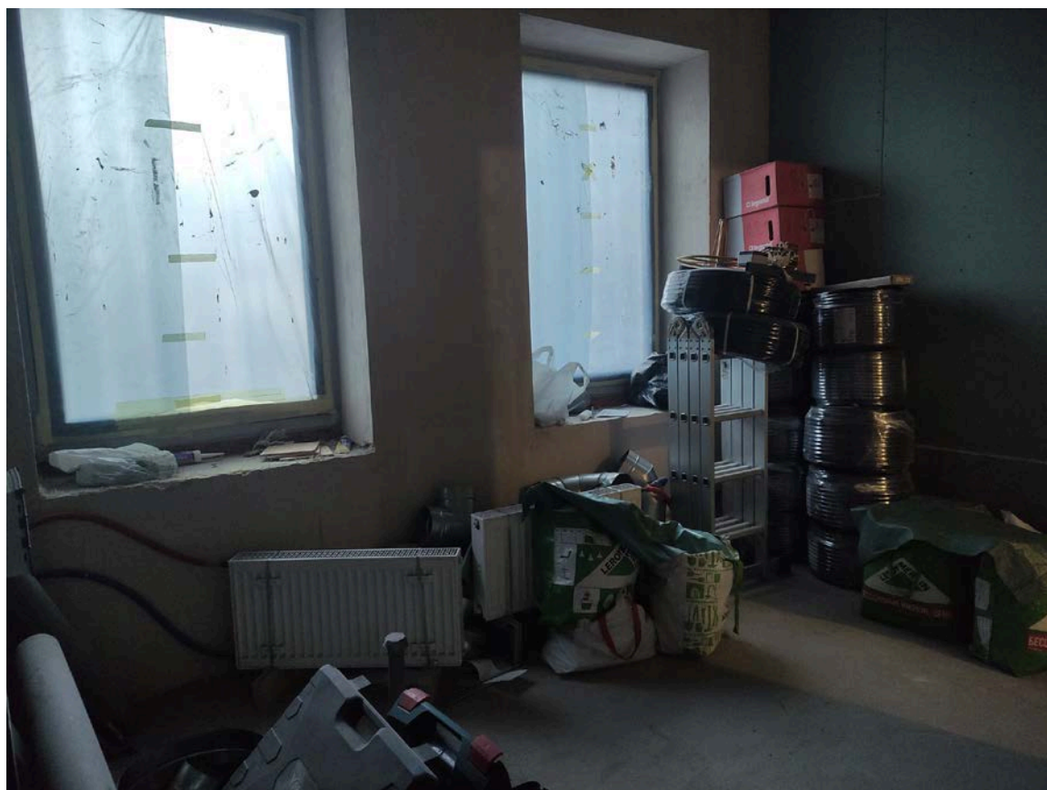
Фото 10. Интерьер квартиры № 118 объекта культурного наследия регионального значения «Дом, в котором жил с 1913 г. и умер в 1935 г. географ и путешественник П.К.Козлов (кв. 32)», ч.п.№ 15
