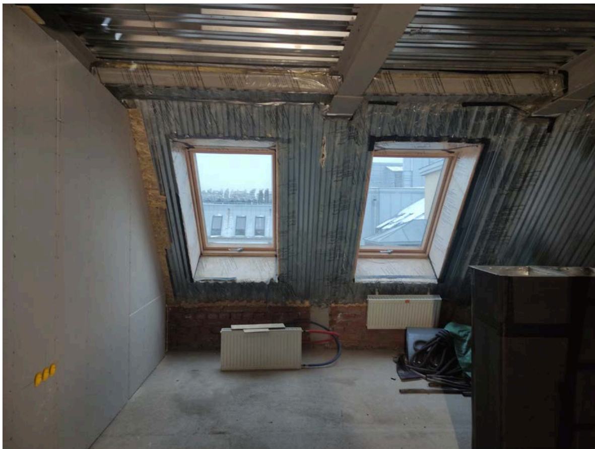
Фото 17. Интерьер квартиры № 118 объекта культурного наследия регионального значения «Дом, в котором жил с 1913 г. и умер в 1935 г. географ и путешественник П.К.Козлов (кв. 32)», ч.п. № 16
