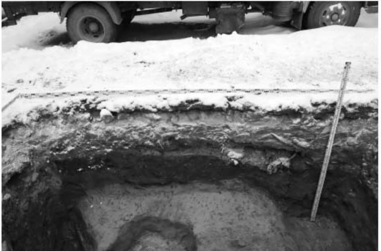
Рис. 53. СПб-2021. Петроградский район, Большая Посадская ул., д. 24/2 лит. С, лит. П. Шурф 3. Восточная стенка. Вид с запада
