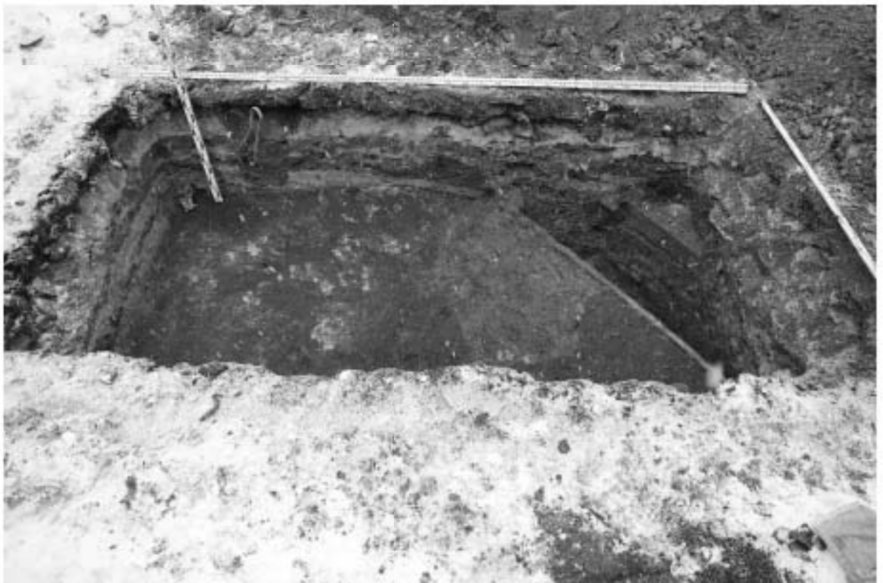
Рис. 48. СПб-2021. Петроградский район, Большая Посадская ул., д. 24/2 лит. С, лит. П. Шурф 3. Фиксация по уровню выявления деревянного короба канализации. Вид с запада
