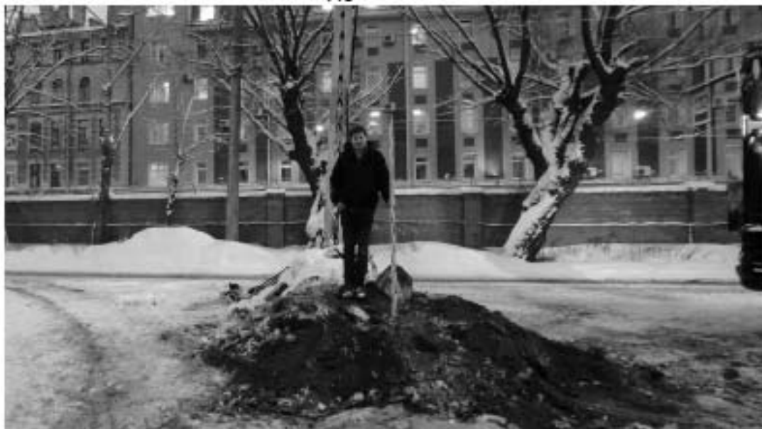
Рис. 65. СПб-2021. Петроградский район, Большая Посадская ул., д. 24/2 лит. С, лит. П. Шурф 4. Рекультивация. Вид с запада
