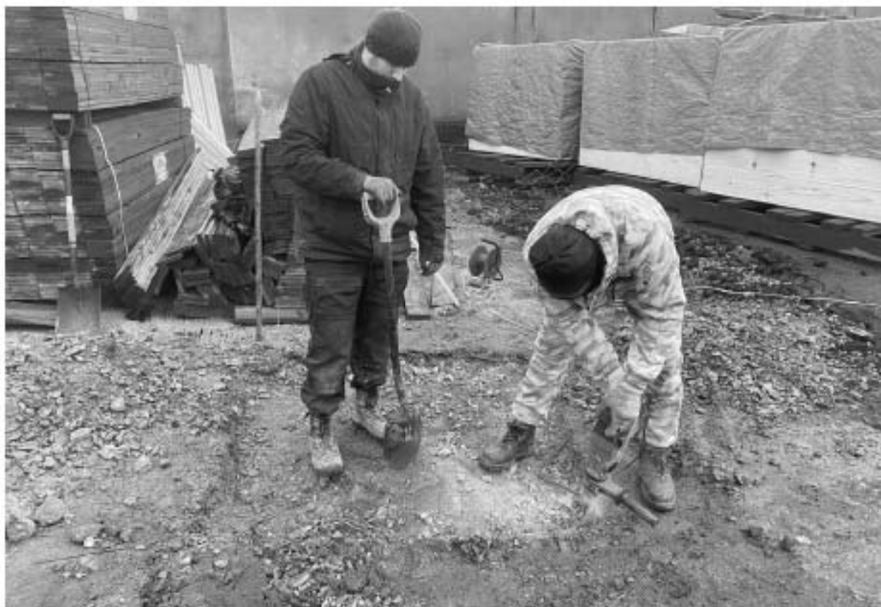
Илл. 17. г. Санкт-Петербург, Партизанская улица, дом 8, литера Е (кад.№ 78:11:0604302:1138). Демонтаж армированной бетонной плиты.
