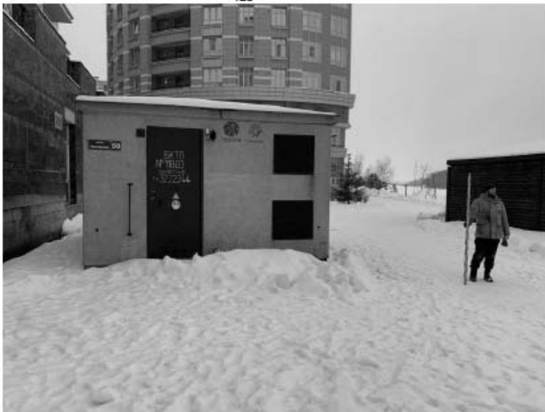
Рис. 60. Санкт-Петербург, Петроградский район, Пионерская ул., Гдовская ул., Новолодожская ул. Точка съемки 12. Общий вид участка обследования. Вид с В.
