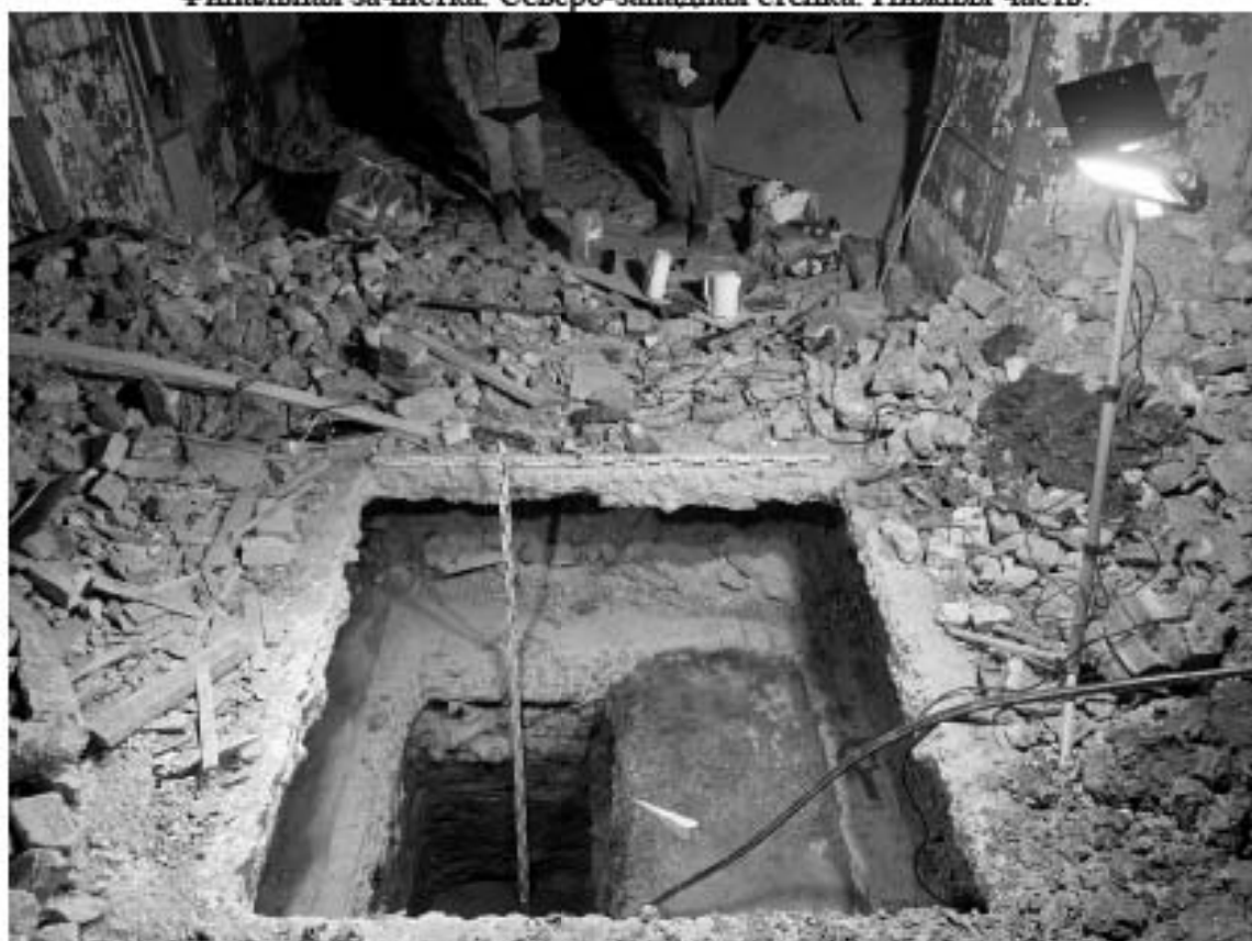
Рис. 67. Санкт-Петербург, Адмиралтейский район, Щепяной пер., д. 4-6, лит. А. Шурф 2. Финальная зачистка. Общий вид СВ стенки. Вид с ЮЗ.
