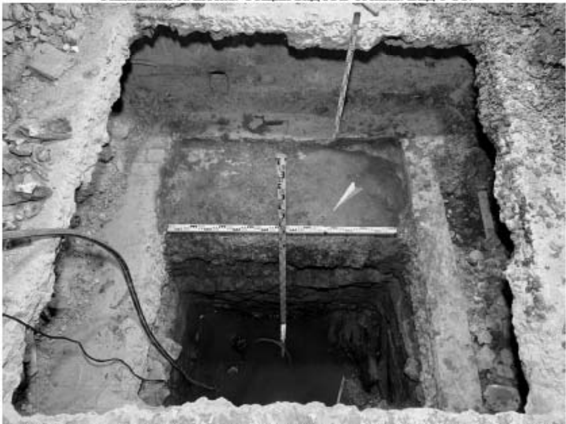
Рис. 71. Санкт-Петербург, Адмиралтейский район, Щепяной пер., д. 4-6, лит. А. Шурф 2. Финальная зачистка. Юго-восточная стенка.
