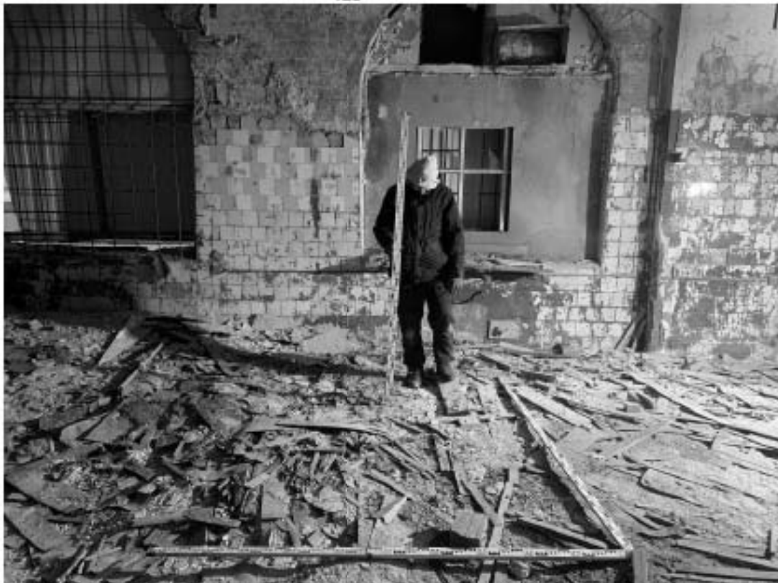
Рис. 58. Санкт-Петербург, Адмиралтейский район, Щепяной пер., д. 4-6, лит. А. Месторасположение Шурфа 2. До начала работ. Вид с ЮВ.
