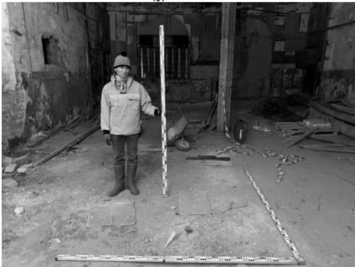
Рис. 25. Санкт-Петербург, Адмиралтейский район, Щепяной пер., д. 4-6, лит. А. Месторасположение Шурфа 1. До начала работ. Вид с СЗ.
