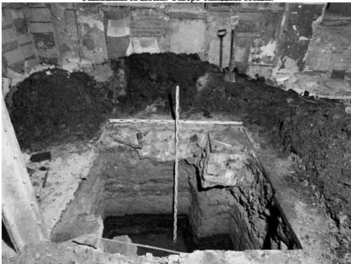
Рис. 30. Санкт-Петербург, Адмиралтейский район, Щепяной пер., д. 4-6, лит. А. Шурф 1. Финальная зачистка. Общий вид СВ стенки. Вид с ЮЗ.
