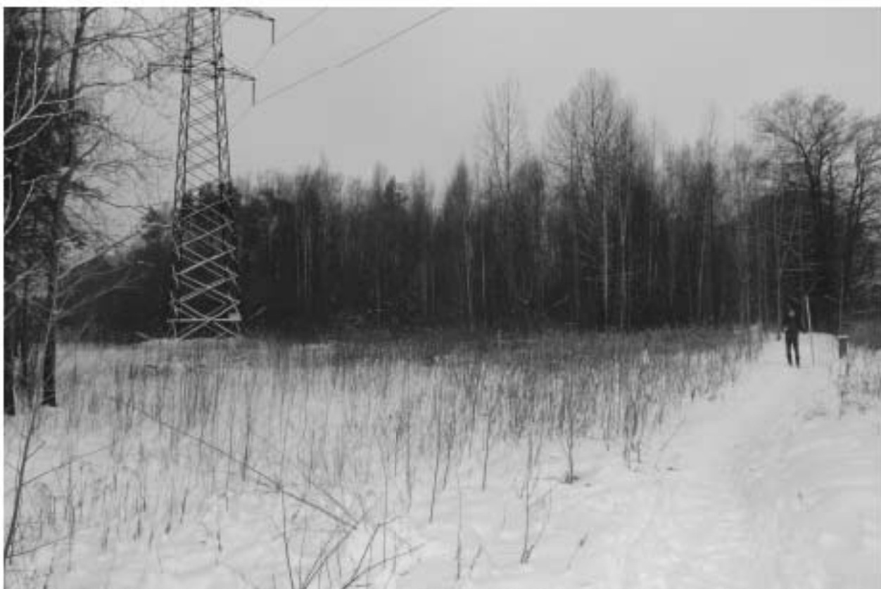
Рис. 25. ВЛ 220 кВ Ручьи–Полупроводники, КВЛ 220 кВ Парголово–Пр. Испытателей-2021. Точка фотофиксации 7, вид на юго-запад.
