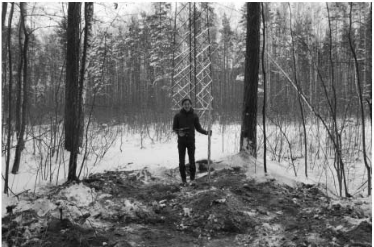
Рис. 55. ВЛ 220 кВ Ручьи–Полупроводники, КВЛ 220 кВ Парголово–Пр. Испытателей-2021. Шурф 2 после рекультивации, вид на восток.
