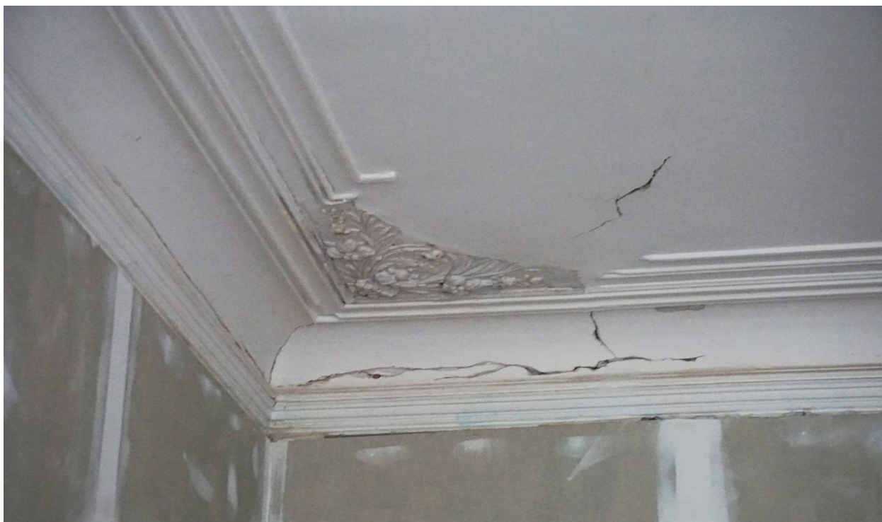
Фото 22. Угловой элемент лепного декора потолка бывшего помещения №7. Вид с юго-востока
