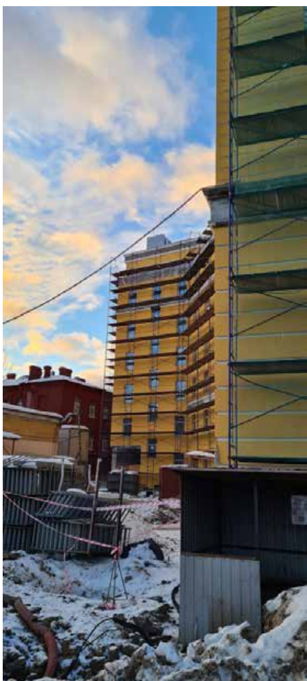
Точка фотофиксации 2. Общий вид южного фасада нового корпуса и примыкающей территории с СВ.
