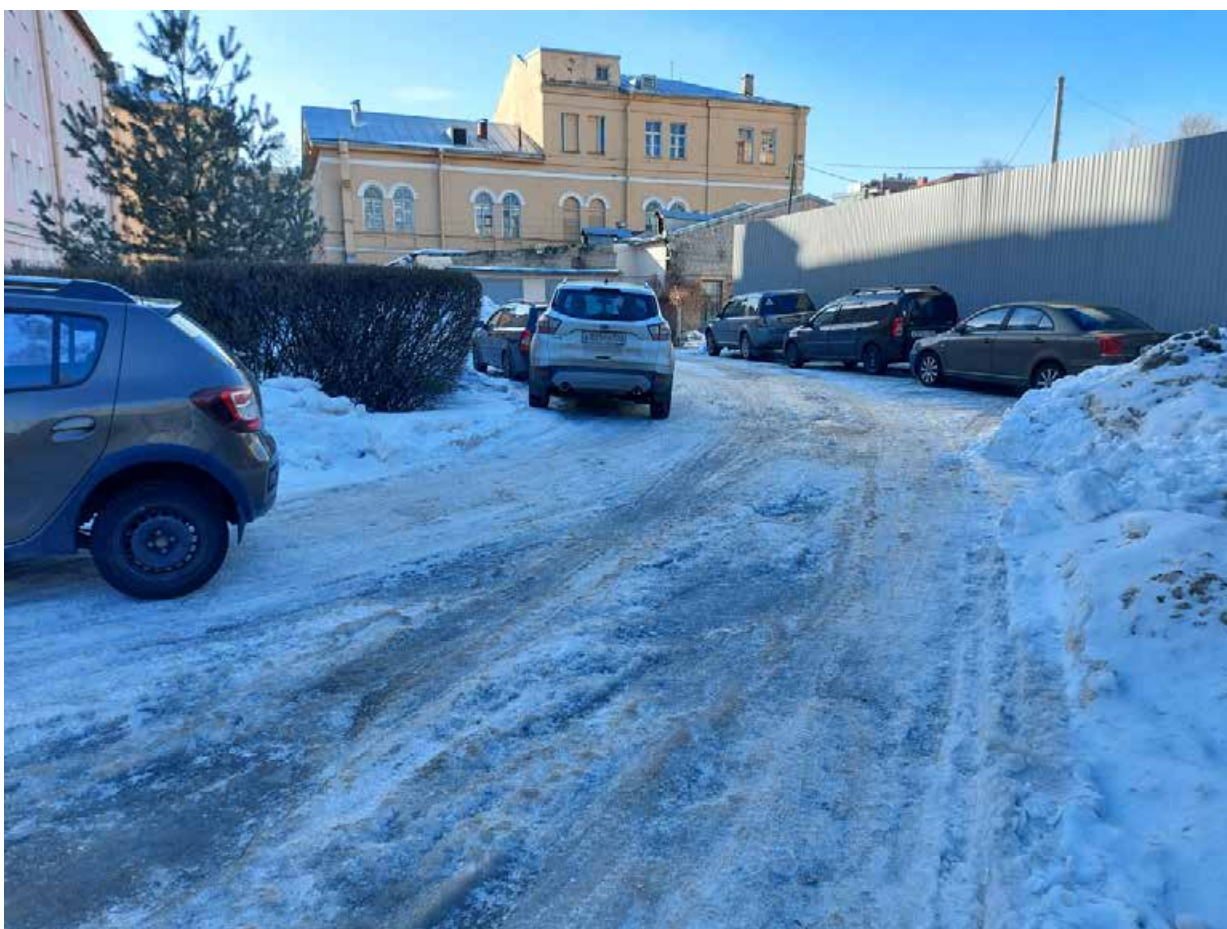
Точка фотофиксации 14. Проезд к западу от корпуса 21, участок прокладки теплотрассы. Вид с СВ.
