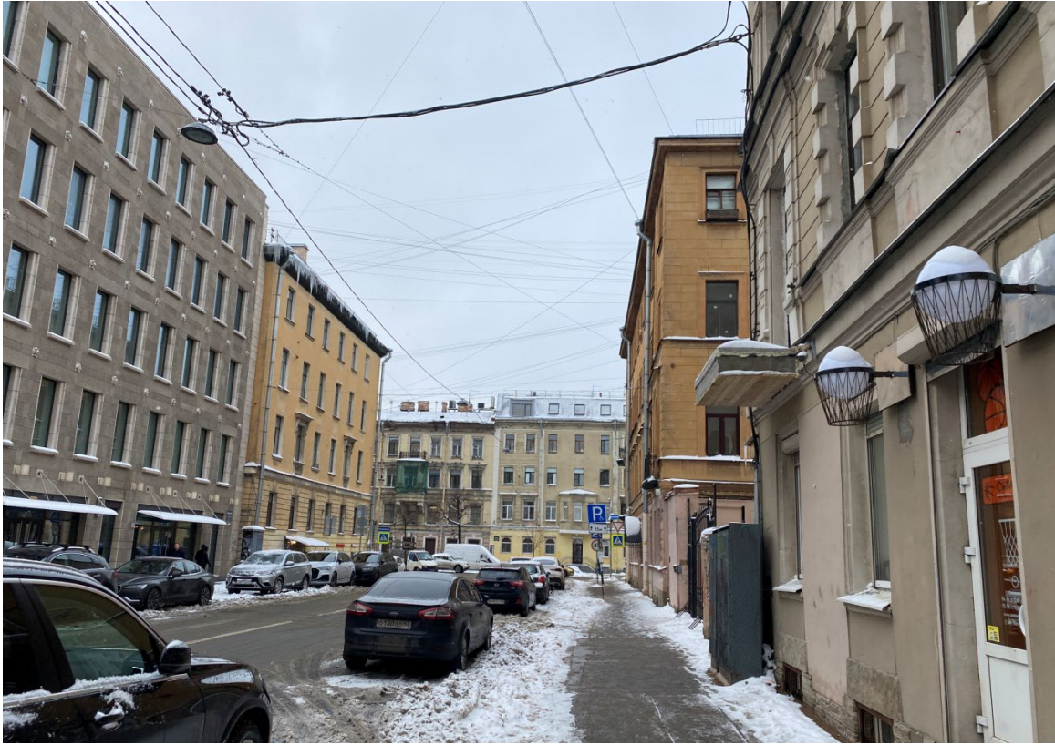
Фото 1. Вид по Ковенскому пер. (электрический кабель прокладывается от существующего пункта питания по адресу Кронверкский пер.2) в сторону ул. Маяковской.
