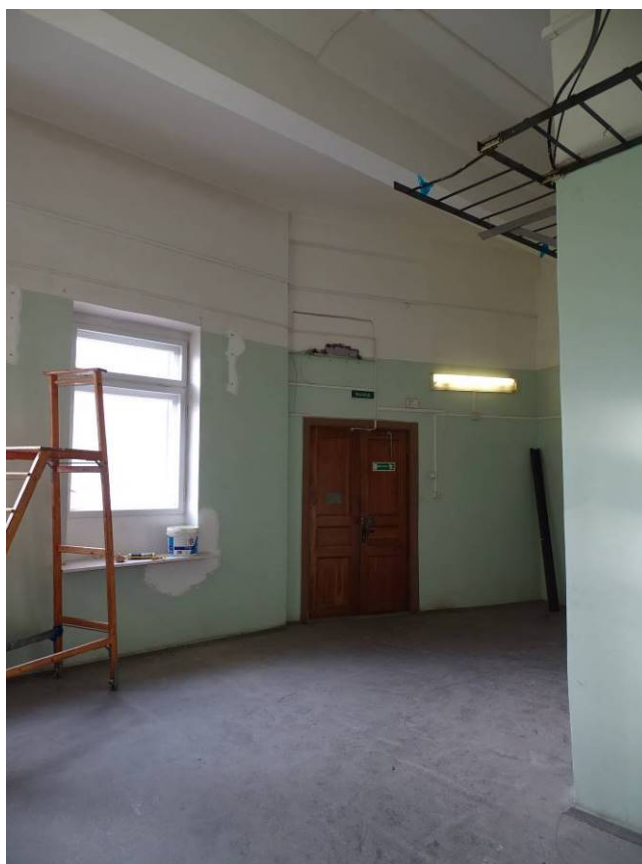
Фото 62. Выявленный объект культурного наследия «Здание Петроградской АТС» 3-й этаж. Пом. 7/28,9. Съемка 15.11.2021 г. Трушковский В.Э.
