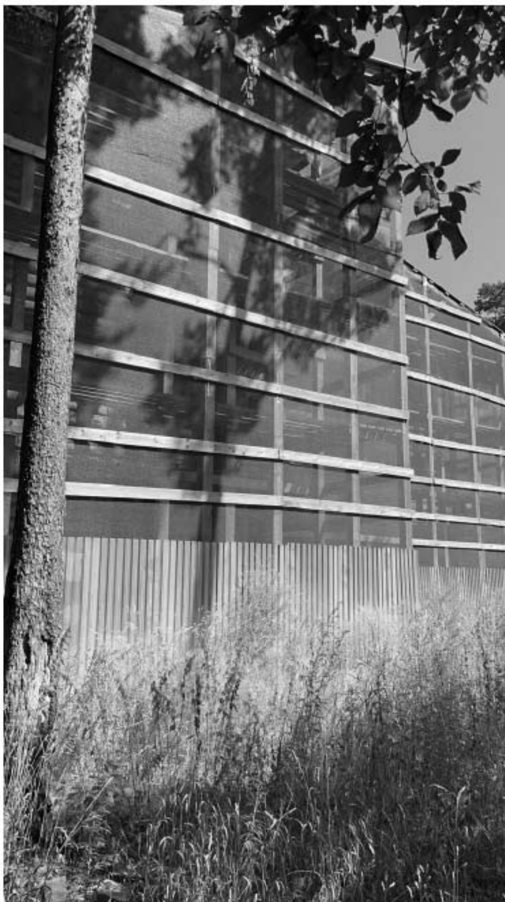
Фото 4. Вид на юго-восточный угол здания в защитном сооружении. Фасад А-Н. Фото 1.07.2021 г.
