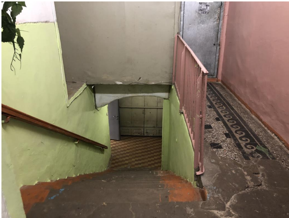
27. Объект культурного наследия регионального значения «Реальное училище с садом и оградой», входящий в состав «Комплекс домов по ул. Пролеткульта», расположенный по адресу: Санкт-Петербург, г. Пушкин, Госпитальная улица, дом 24, литера А. Лестница в подвальное помещение.
