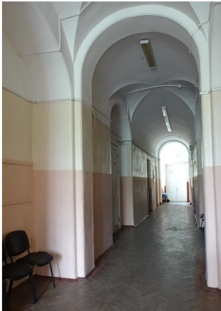
40. Объект культурного наследия регионального значения «Реальное училище с садом и оградой», входящий в состав «Комплекс домов по ул. Пролеткульта», расположенный по адресу: Санкт-Петербург, г. Пушкин, Госпитальная улица, дом 24, литера А. Второй этаж. Коридор (помещение №50). Общий вид.
